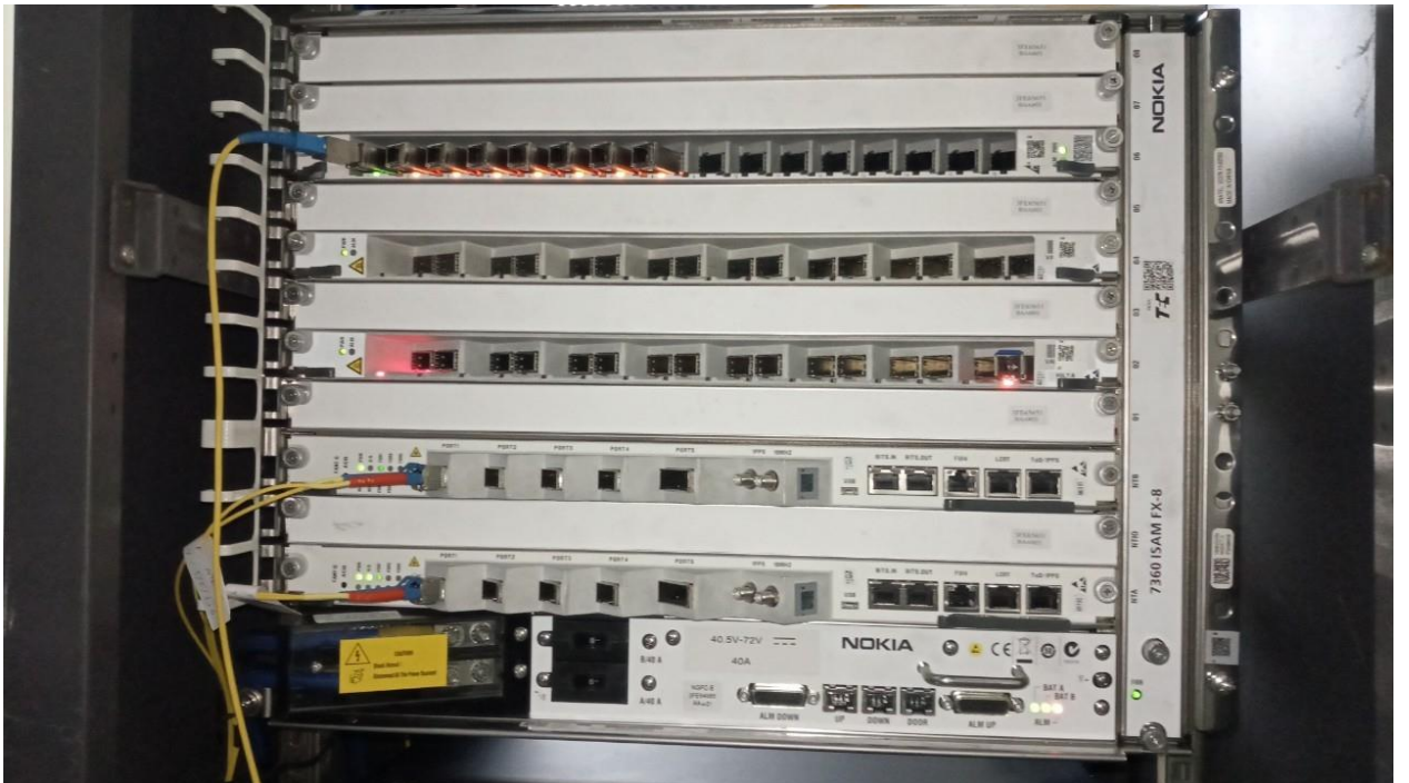
OLT lắp đặt tại trạm Lạch Tray
