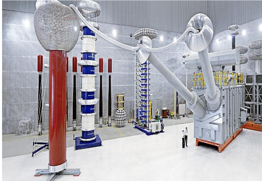
Hình 1.9. Máy biến áp trong hệ thống HVDC
