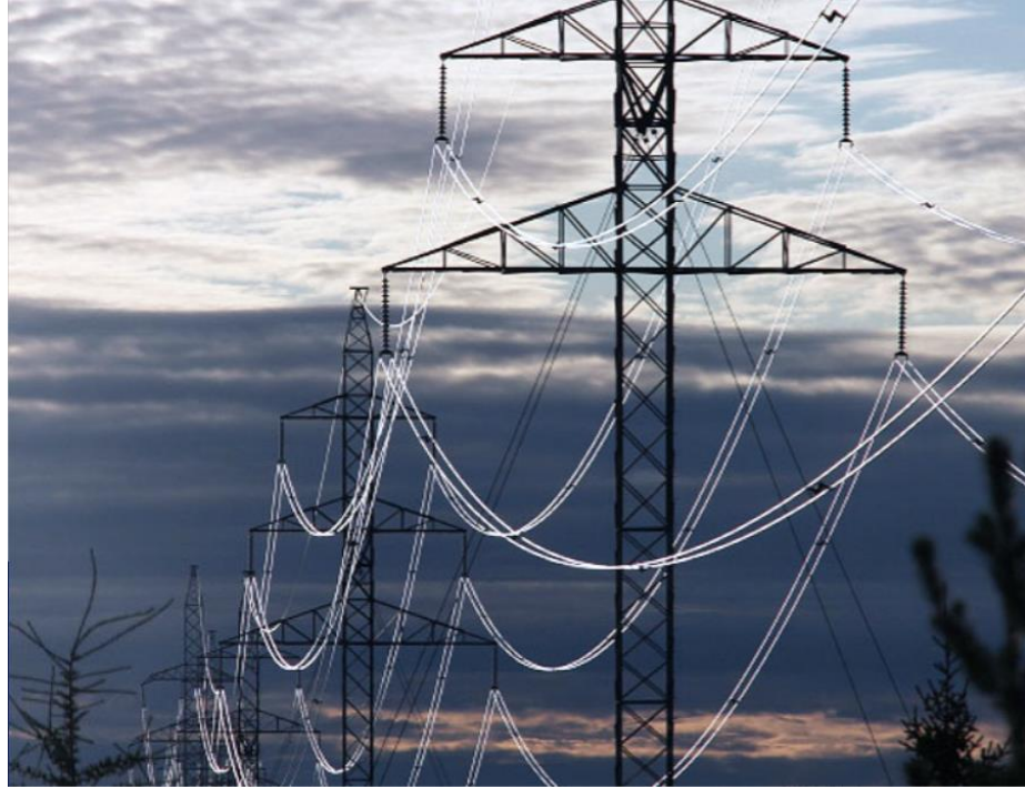
Hình 1.10. Đường dây truyền tải HVDC
