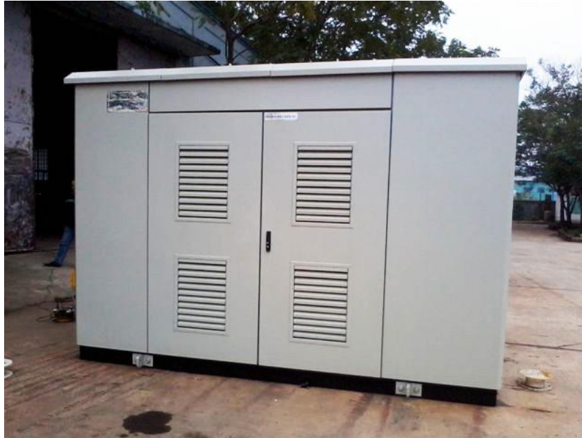
Hình 2.4: Trạm biến áp hợp bộ (kiosk)
