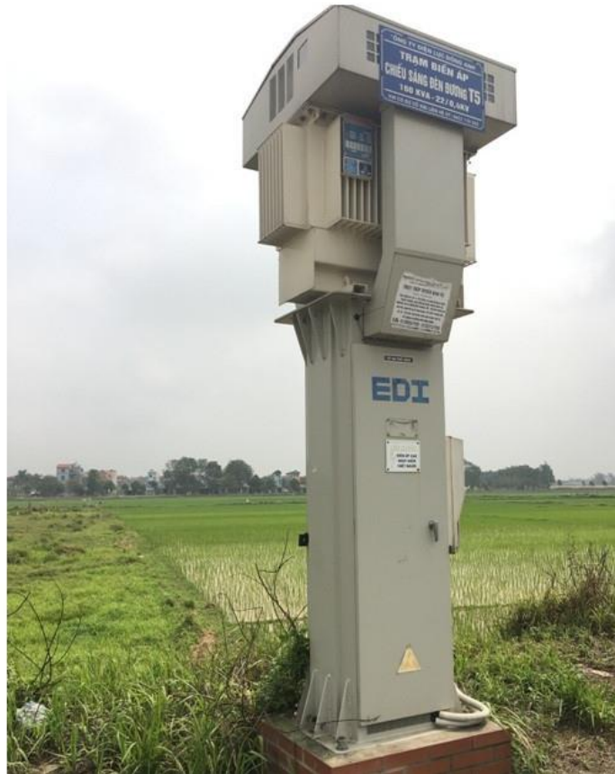
Hình 2.5: Trạm biến áp một cột
