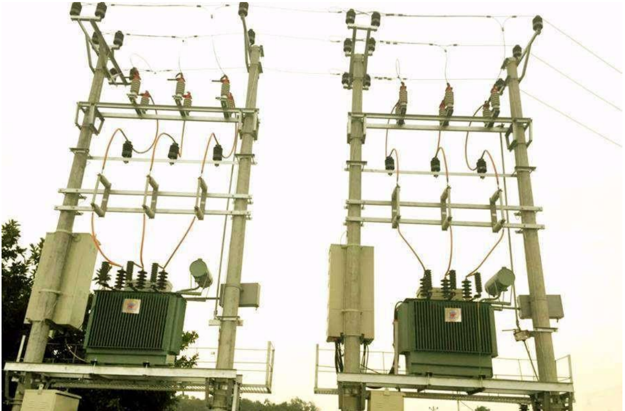
Hình 2.3: Trạm biến áp treo
