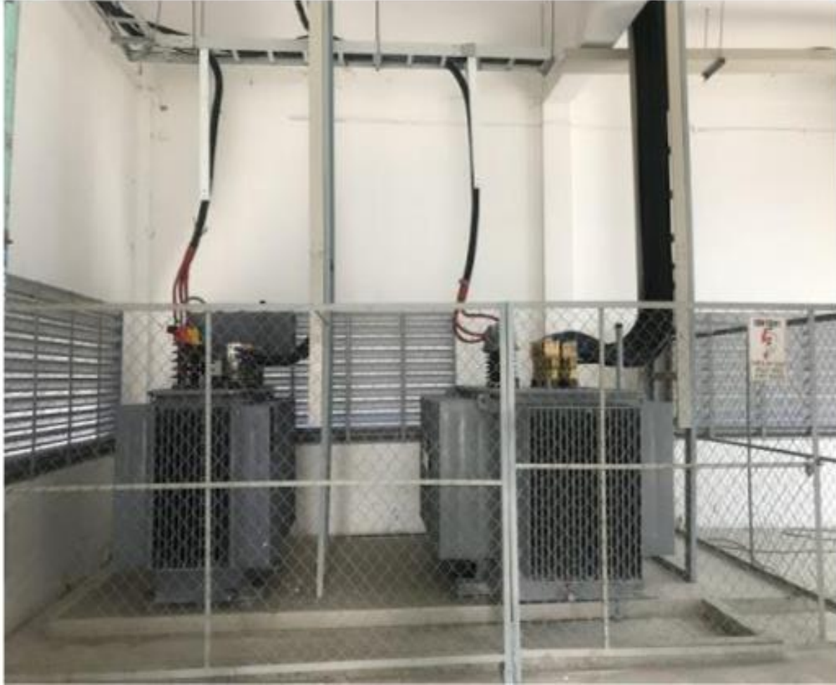
Hình 3.2: Trạm biến áp trong nhà
