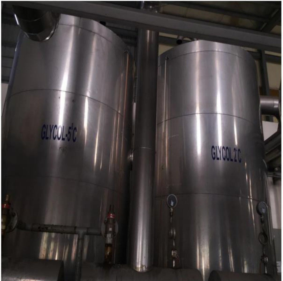
Hình 3.15. Tank chứa Glycol.
