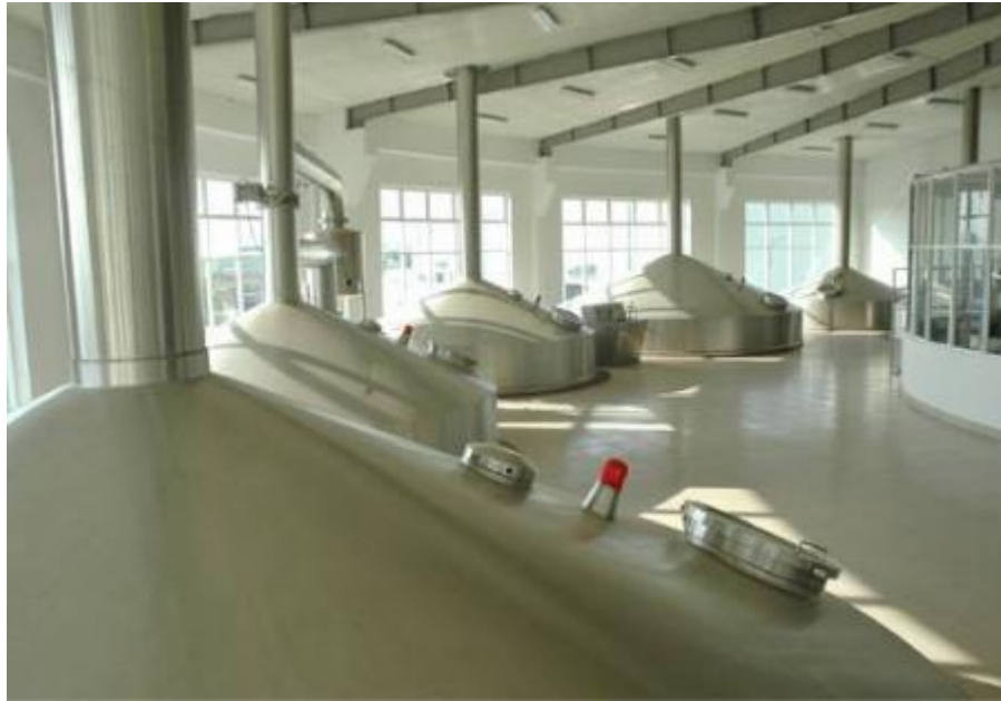
Hình 1.8. Hệ thống nấu nhà máy bia Heineken.
