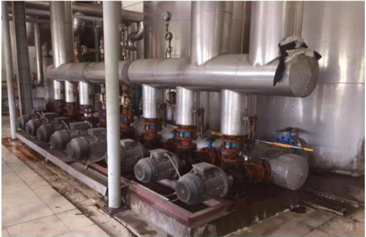
Hình 3.16. Bơm tuần hoàn và bơm cấp Glycol.
