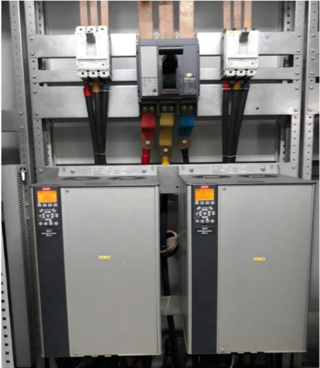
Hình 3.4. Mặt trong tủ điều khiển.
