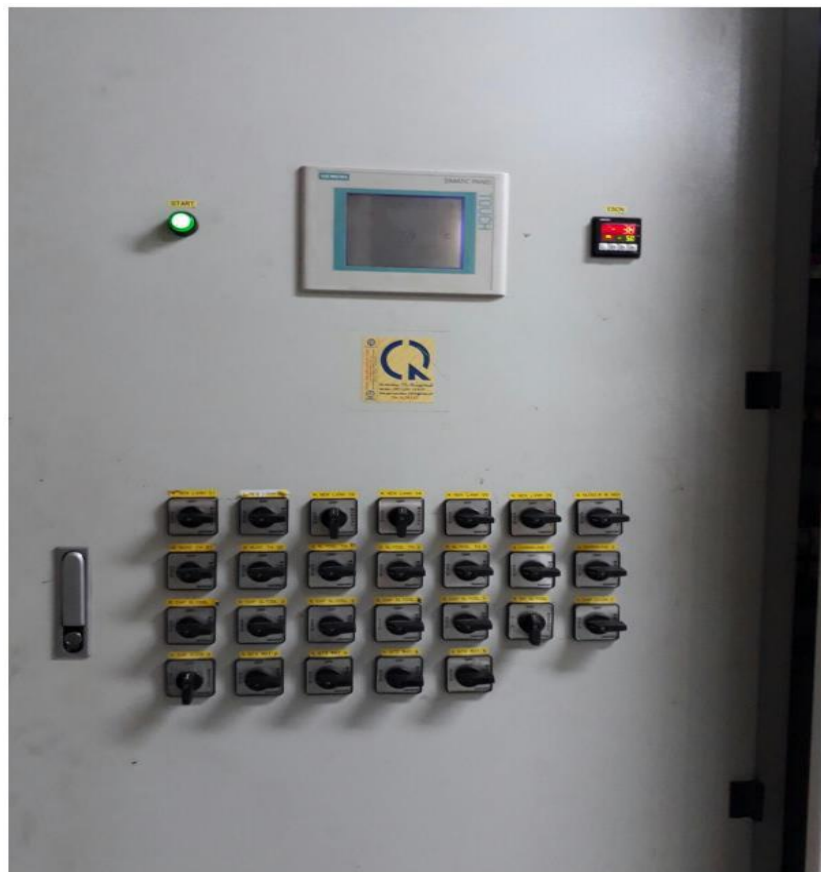
Hình 3.6. Các công tắc COS điều khiển hệ thống lạnh.
