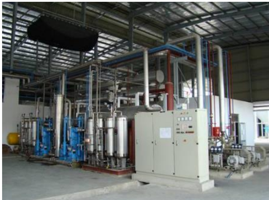
Hình 1.15. Hệ thống thu hồi CO 2 Công ty bia Heineken.
