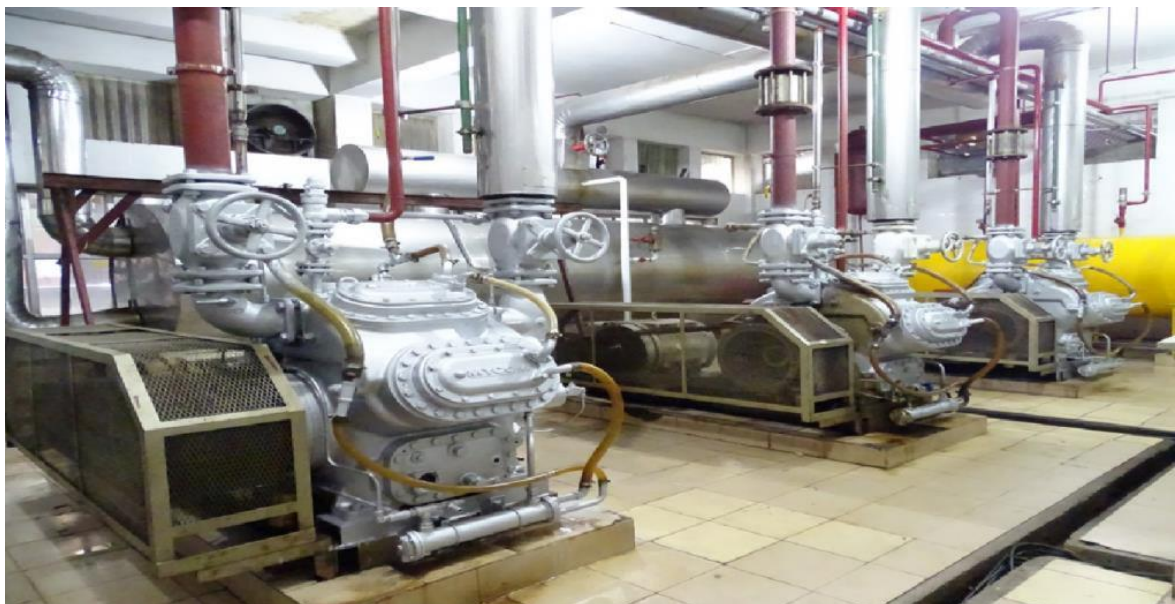
Hình 3.2. Toàn bộ hệ thống lạnh.
