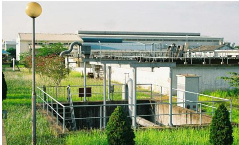
Hình 2.2 Khu xử lý nước thải tập trung KCN Nomura
