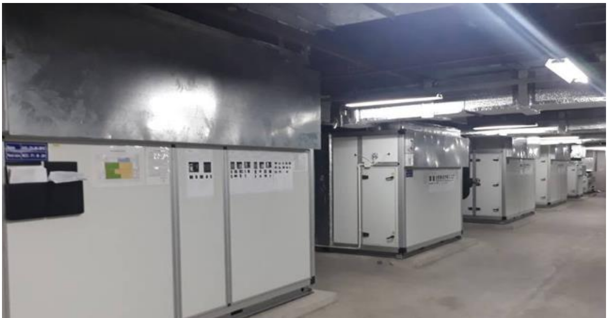
Hình 1.3: Hình ảnh về hệ thống AHU.
