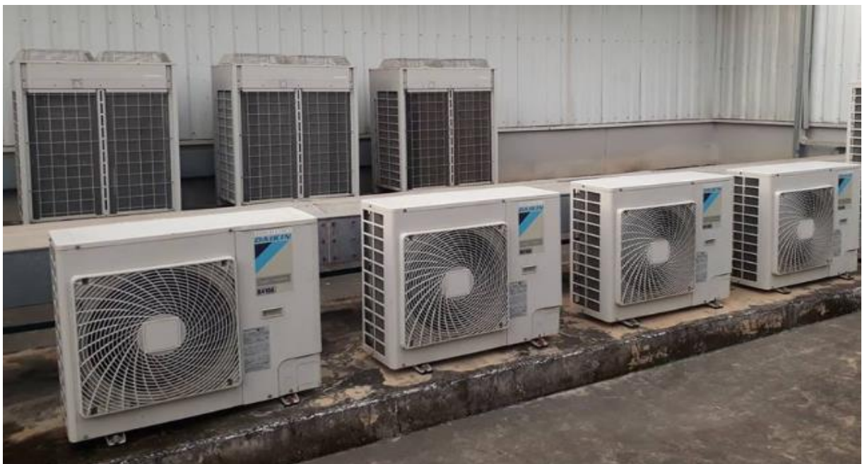
Hình 1.5: Hình ảnh về hệ thống điều hòa cục bộ.
