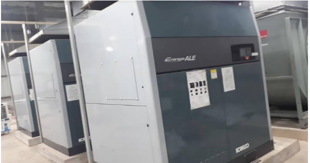
Hình 1.4: Hình ảnh về hệ thống máy nén khí.
