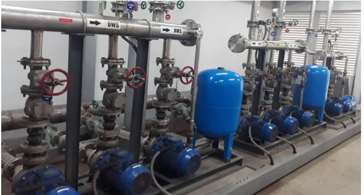
Hình 1.6: Hình ảnh về hệ thống bơm sinh hoạt.
