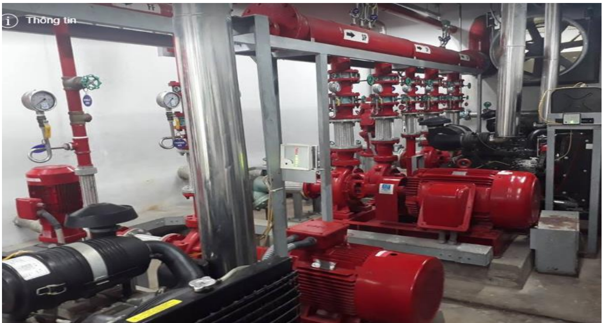
Hình 1.7: Hình ảnh về hệ thống bơm cứu hỏa.
