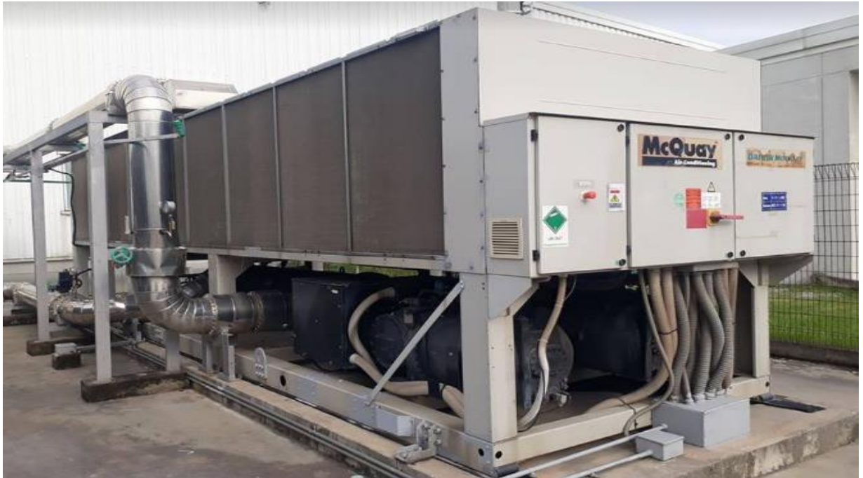
Hình 1.2.: Hình ảnh về hệ thống chiller.
