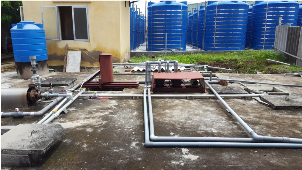
Hình 1. 2. Hệ thống xử lý nước thải của công ty Cổ phần chế biến dịch vụ và thủy sản Cát Hải
