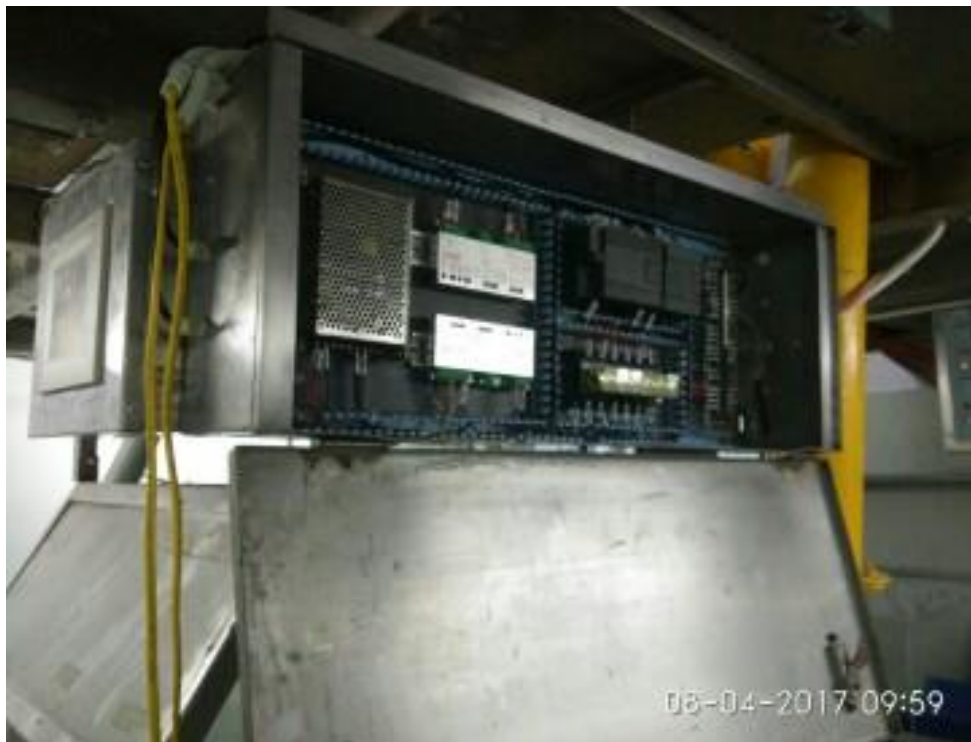
Hình 3.0 Hình ảnh tủ điều khiển thực tế
