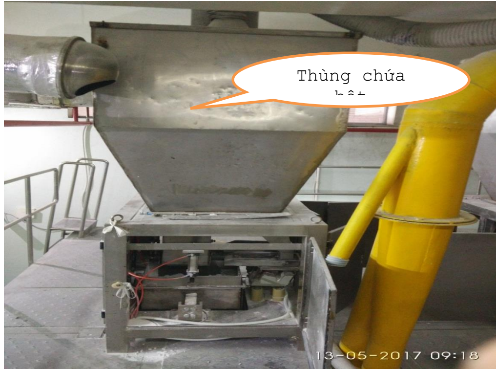
Hình 1.2 Bồn chứa một hệ thống cân
