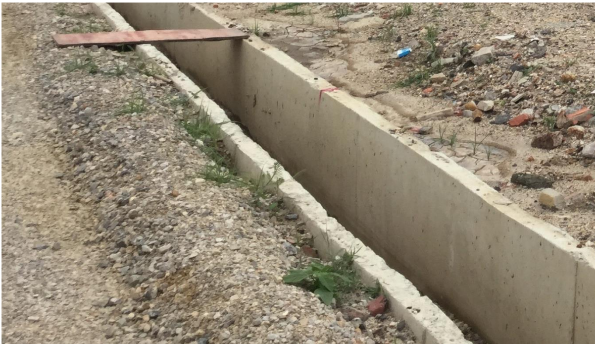
Hình 1.10: Hố ga BTCT thu gom mạng lưới nước mưa
