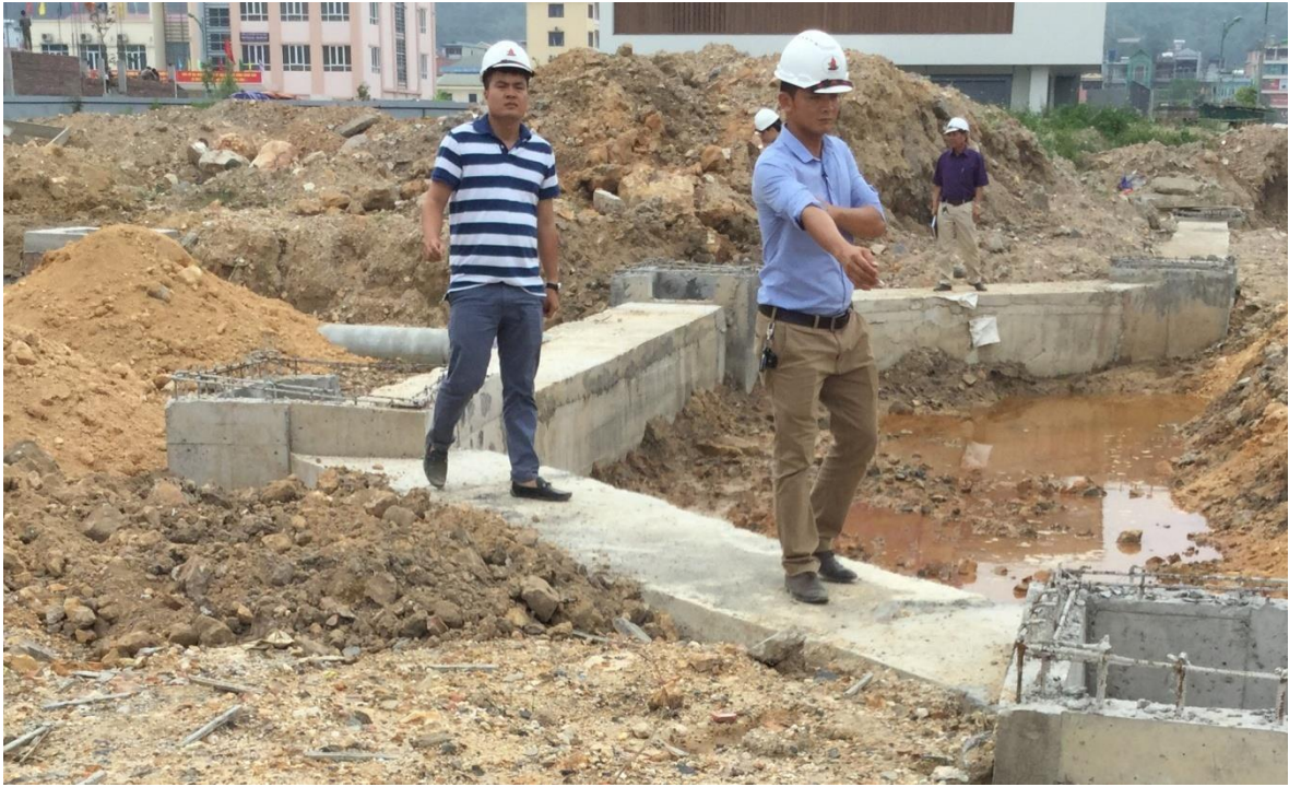
Hình 1.11: Mạng lưới hố ga BTCT thu gom nước thải
