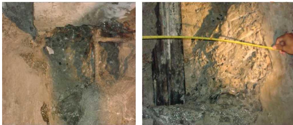
Hình 1.4: Thấm qua vị trí khuyết tật, mạch ngừng bê tông, khe co giãn Công trình 102 Trường Chinh
