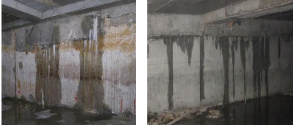
Hình 1.3: Thấm qua tường, vách bê tông tầng hầm Công trình 8B Lê Trực
