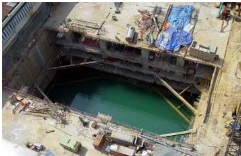
Hình 1.9. Sự cố tầng hầm Pacific 5 tầng hầm [8]
