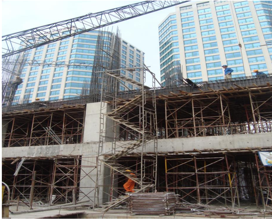
Hình 1.3. Đồng thời với phần ngầm hai tầng dưới thuộc phần thân tòa nhà này cũng đang được thi công[8]
