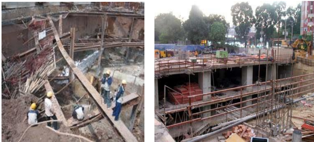
Hình 1.7. Sự cố nước bùn cát chảy vào đáy hố móng [8]
