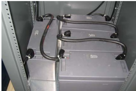
Hình 3.11. Hệ thống ắc quy
