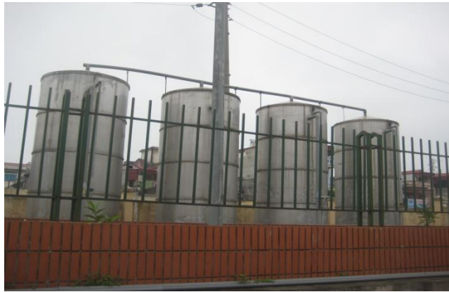
Hình 2.19- Hệ thống xử lý nước thải bệnh viện Đa khoa Hải Dương.
