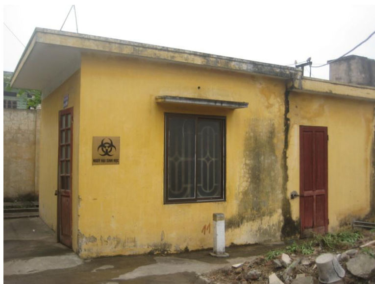
Hình 2.15- Nhà chứa rác
