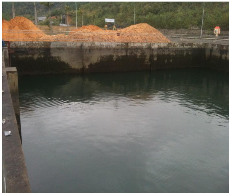
Hình 3.13. Bể nước sạch
