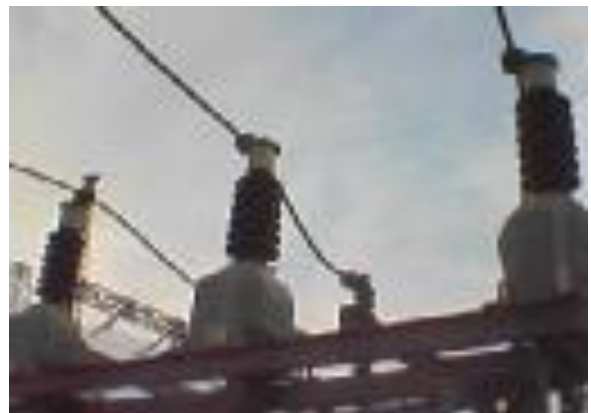
Hình2.7. Máy biến điện áp TU - C31, 35kV
