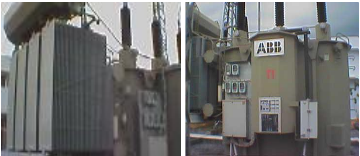
Hình 2.1. Máy biến áp 110 kV
