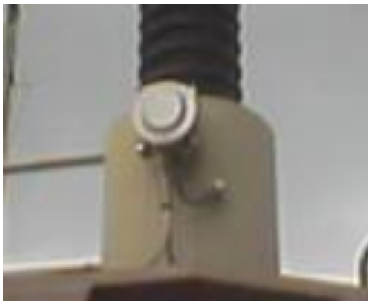
Hình 2.4. Máy biến dòng điện 110 kV kiểu ITGEF 0,72
