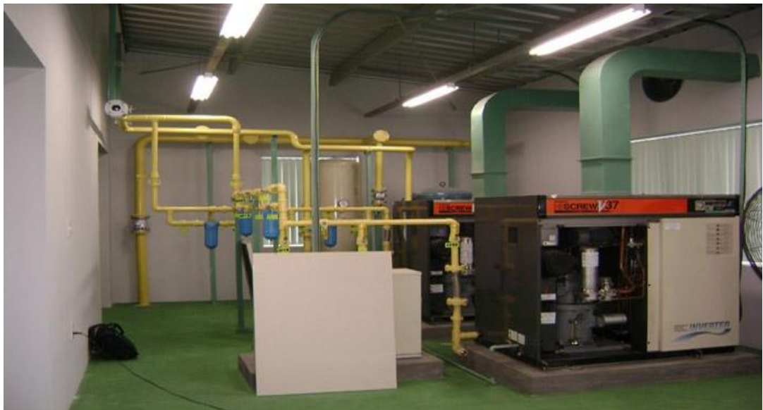
Hình 1.11: Hệ thống khí nén trong nhà máy thực phẩm
