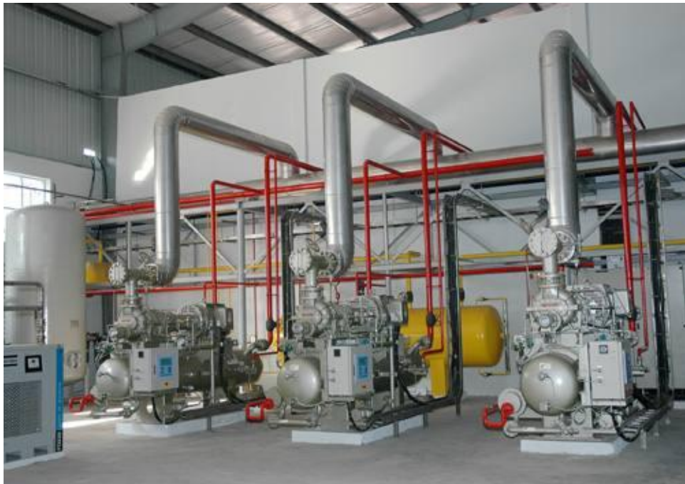
Hình 1.16. Hệ thống máy nén lạnh Nhà máy Bia Sài Gòn - Hà Nội
