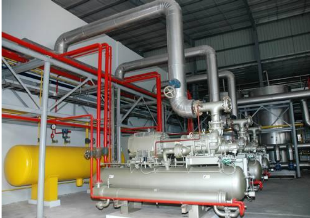
Hình 1.17. Hệ thống máy nén lạnh Nhà máy Bia Sài Gòn - Bình Tây
