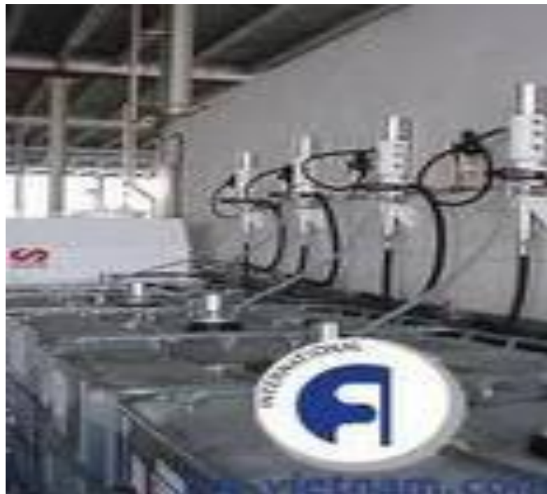
Hình 1.1. Hệ thống bơm dầu FO, DO
