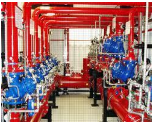
Hình 1.7. Hệ thống bơm chữa cháy
