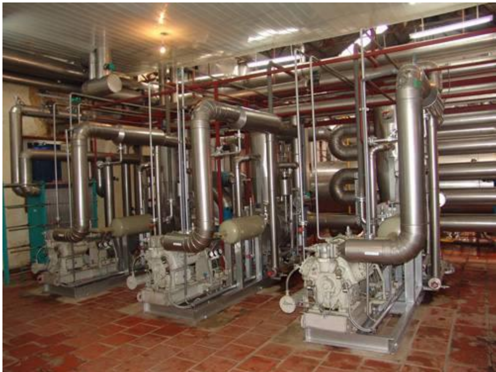
Hình 1.18. Hệ thống máy nén lạnh Bia Thanh Hoá
