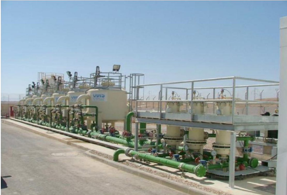
Hình 1.1 Nhà máy xử lý nước thải thành phố
