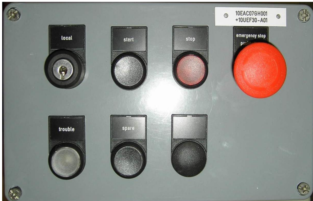
Hình 4.1: Bảng điều khiển tại chỗ của băng
