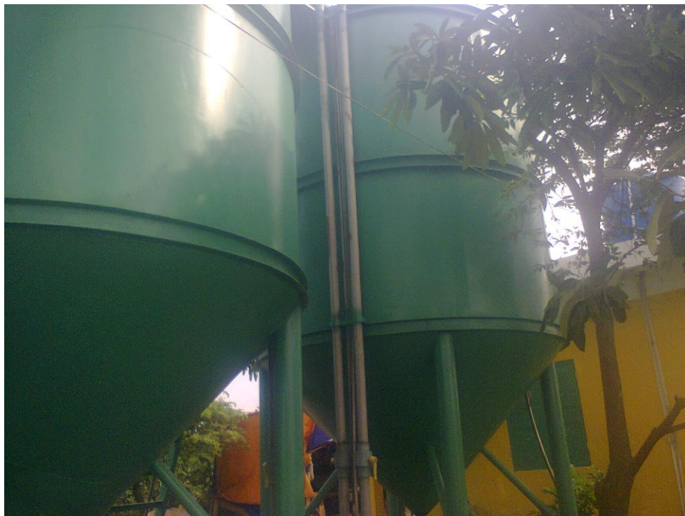
Hình 3.5 Hệ thống xử lý nước rỉ rác
