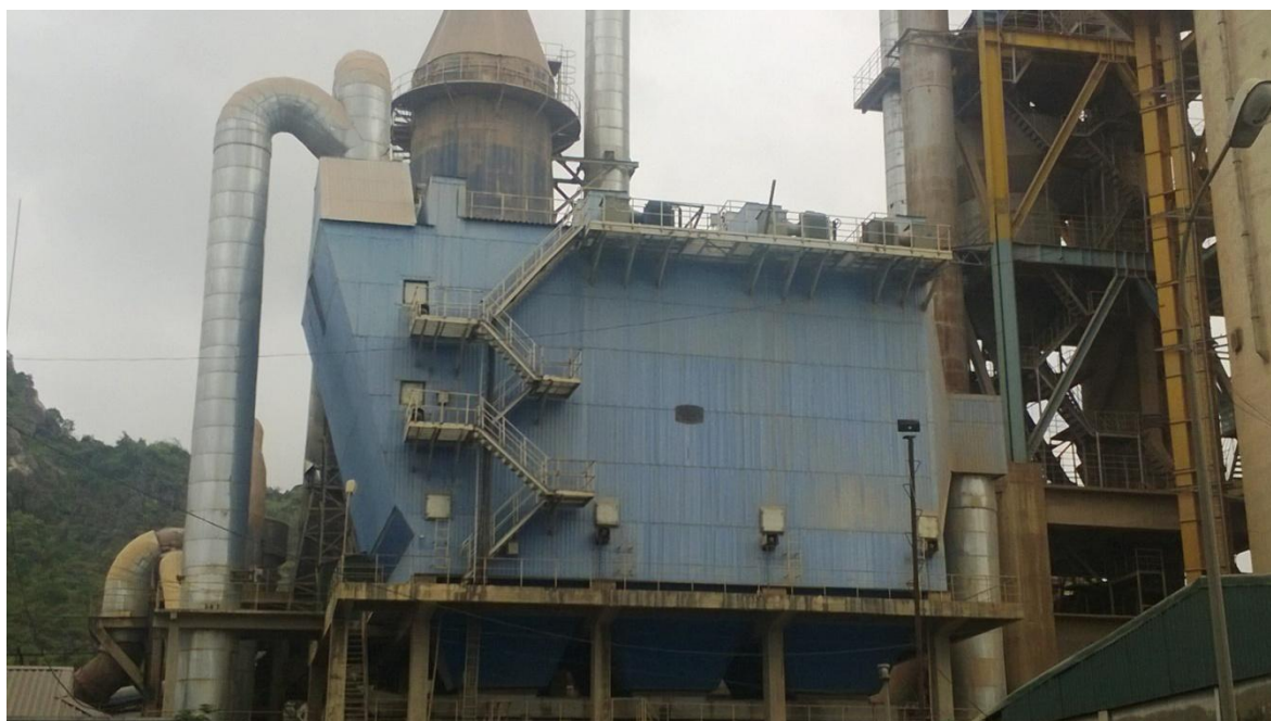
Hình 2.3: Thiết bị lọc bụi tĩnh điện tại công ty xi măng Lam Thạch
