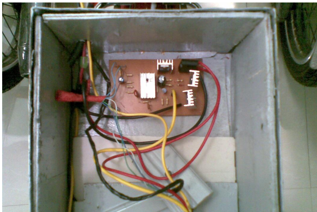
Hình 2.10. Mạch điều tốc được để trong hộp điện
