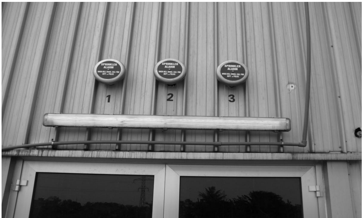
Hình 1.3. Chuông báo động sự cố cháy của siêu thị
