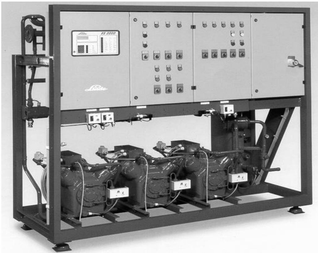
Hình 2.2 Tủ điều khiển và hệ thống máy nén
