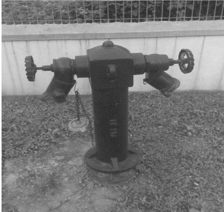
Hình 3.3. Trụ cứu hỏa đặt ngoài tòa nhà siêu thị
