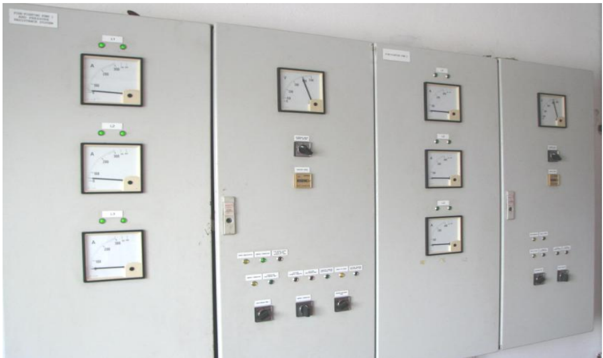
Hình 3.2. Bảng tủ điện điều khiển hệ thống cứu hỏa
