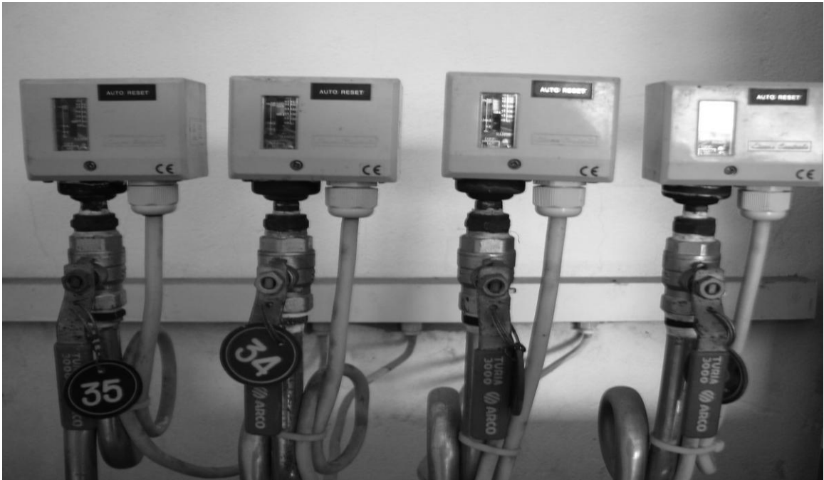
Hình 1.8. Role áp suất dừng trong hệ thống cứu hỏa của siêu thị Metro
