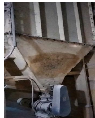
TB lọc bụi túi vải của dự án
