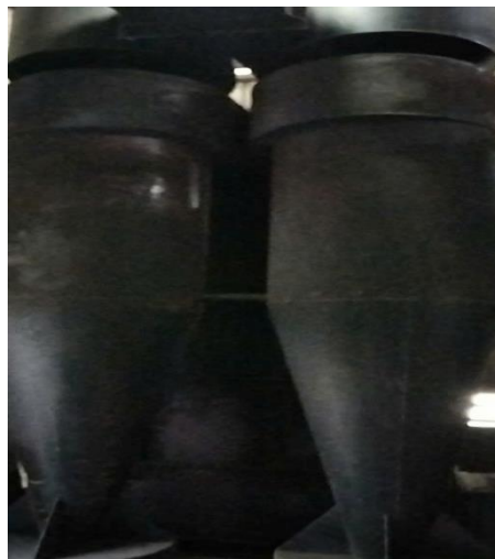
Hình 2.17. Hình ảnh Cyclone kép của HTXLKT lò hơi
