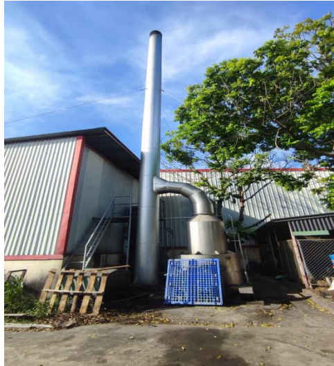
Hình 2.18. Hệ thống tháp lọc bụi ướt xử lý khí thải lò hơi của nhà máy
