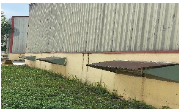
Hình 2.19 . Hình ảnh hệ thống thông gió nhà xưởng của nhà máy
