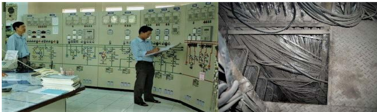
Hình 2.4 – Phòng điều khiển (trái) và hầm cáp (phải) của một hệ thống điều khiển truyền thống
