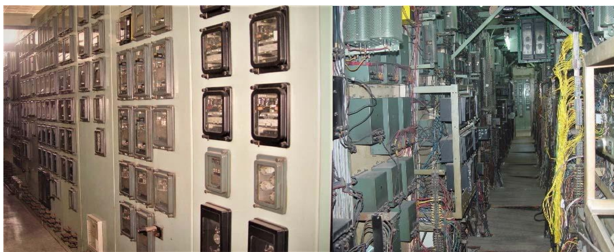
Hình 2.5 – Mặt ngoài (trái) và mặt trong (phải) của hệ thống role cơ trong hệ thống điều khiển truyền thống trạm biến áp Thủ Đức trước năm 2002 [6]
