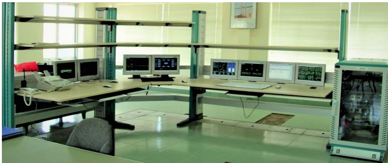
Hình 2.7 – Phòng điều khiển hệ thống điều khiển tích hợp theo tiêu chuẩn IEC 61850 cho trạm biến áp 220/110 kV Thủ Đức. Tủ role bảo vệ chỉ gồm các thiết bị IED đảm nhiệm chức năng bảo vệ và điều khiển cho các ngăn lộ, giới thiệu ở hình 2.8. Sự ra đời của các thiết bị IED và tiêu chuẩn IEC 61850 giúp giảm số lượng thiết bị và các role trung gian trong quá trình hoạt động của hệ thống bảo vệ.
