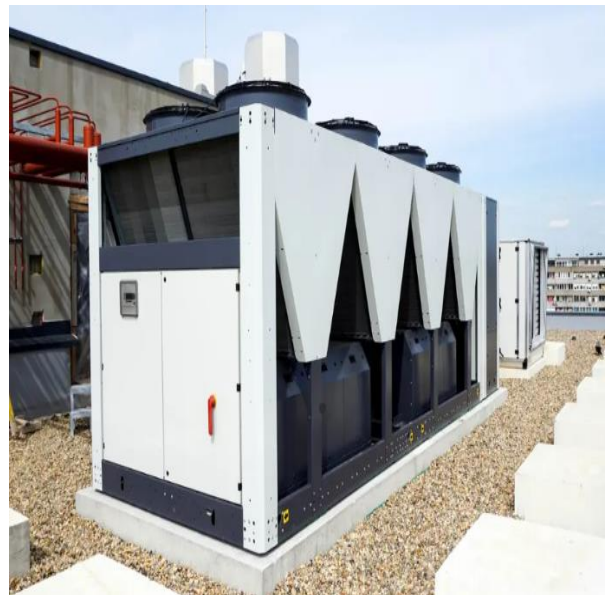
Hệ thống Chiller
