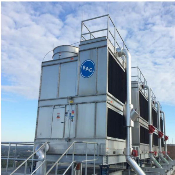
Hệ thống Cooling Tower
