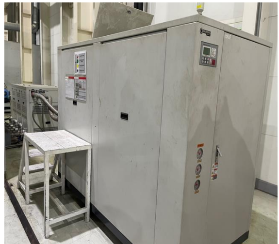
Hệ thống Chiller
