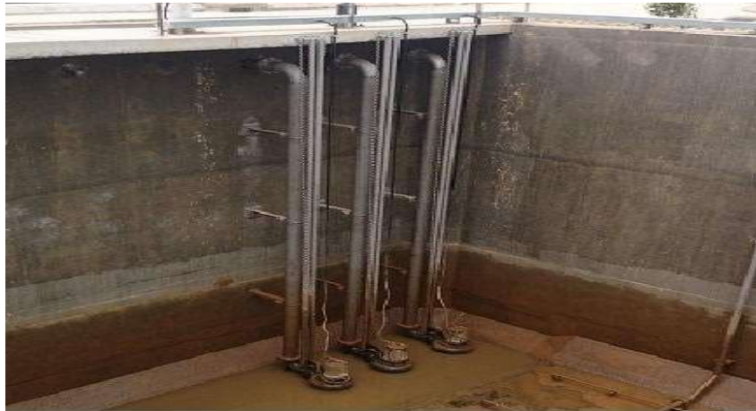
Hình 3.2. Cụm các bơm nước thải
