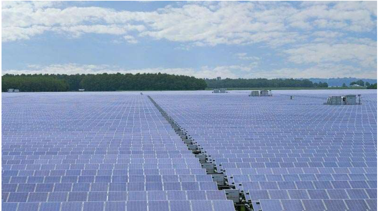
Hình 1.4. Cụm nhà máy điện mặt trời Dầu Tiếng DT1 và DT2 có quy mô đứng thứ hai trong số các nhà máy điện mặt trời ở Việt Nam
