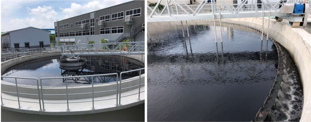
Hình 2.12. Bể lắng hóa lý
