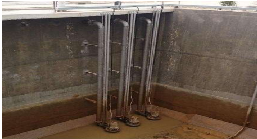
Hình 3.2. Cụm các bơm nước thải
