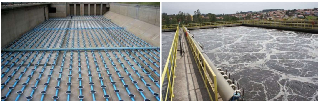
Hình 2.9. Hệ thống phân phối khí bằng máy thổi khí trong Bể sinh học hiếu khí. Hỗn hợp bùn hoạt tính và nước thải gọi là dung dịch xáo trộn (mixed liquor), hỗn hợp này sẽ chảy qua bể lắng bùn sinh học .
