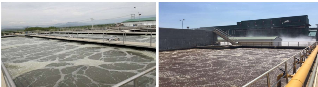
Hình 2.7. Hình ảnh của Bể điều hòa
