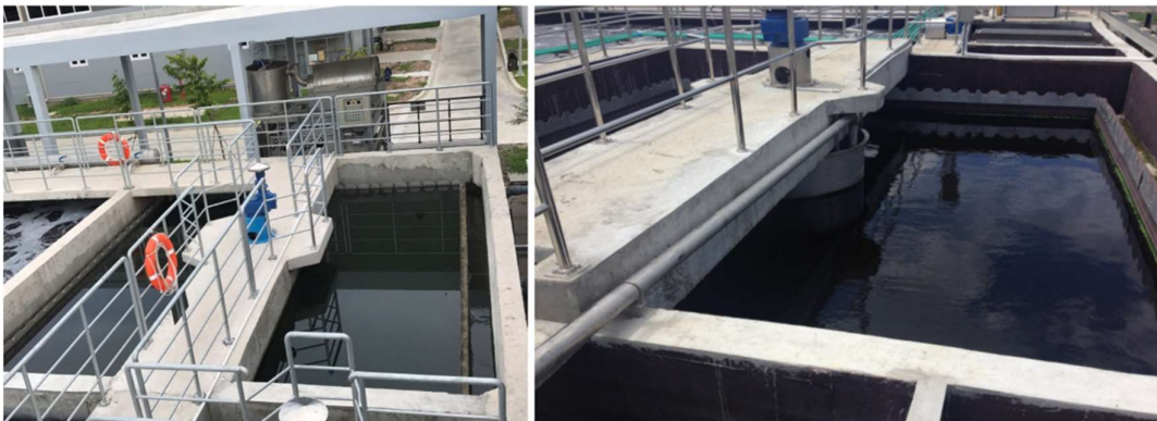
Hình 2.11. Bể keo tụ - tạo bông
