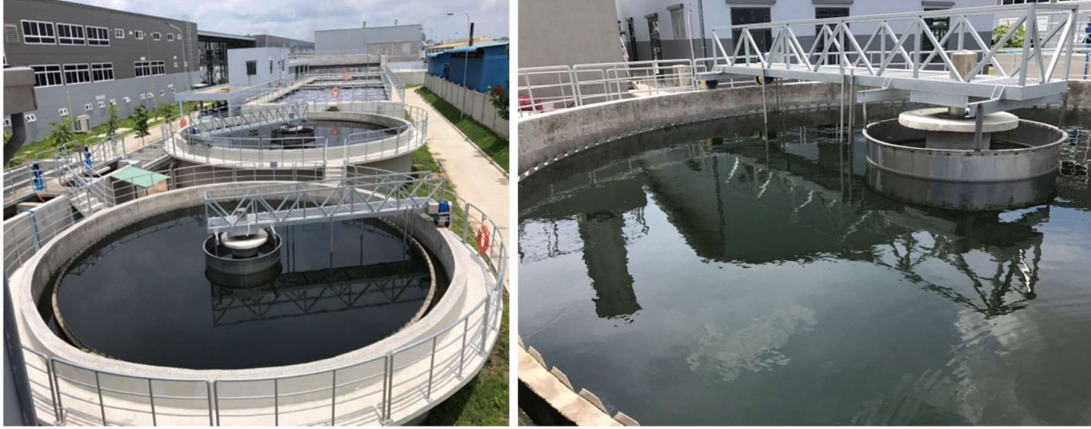
Hình 2.10. Bể lắng bùn sinh học
