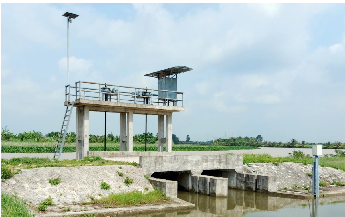
Hình 3.3. Công Đồng Cung được vận hành bằng năng lượng mặt trời
