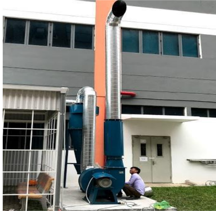
Hình 3.3. Ống phóng không và quạt hút của hệ thống lọc bụi bằng cyclone
