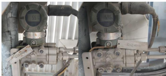
Hình 3.6: Transmitter đo mức 62LT605A/B
