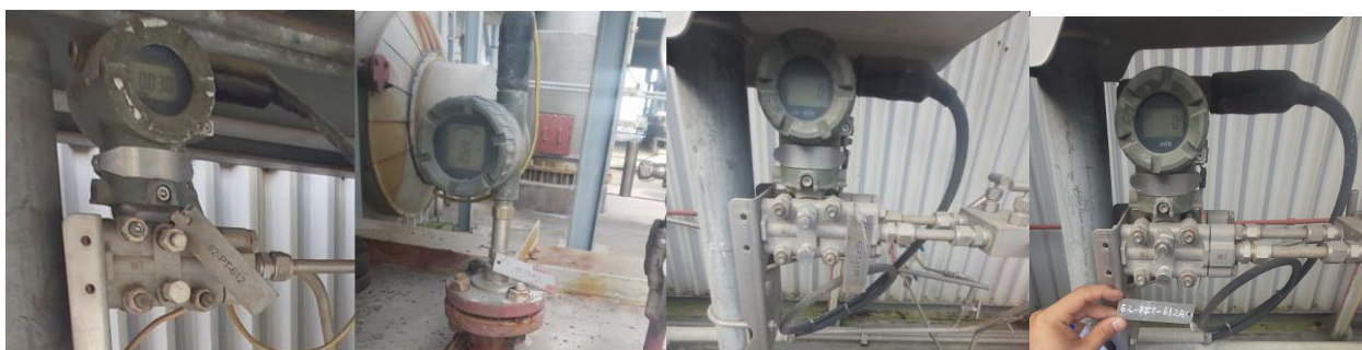
Hình 3.11: 62PT612, 62TT612 và 62FT612A/B
