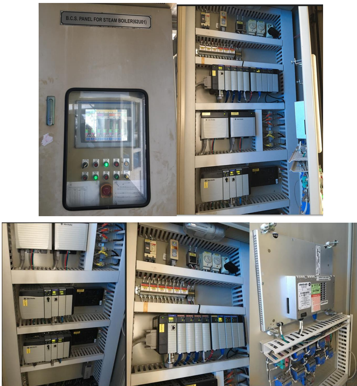
Hình 3.14: Một số hình ảnh thực tế của tủ PLC
