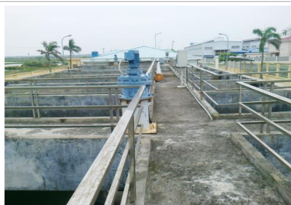
Trạm cấp nước sạch của KCN
