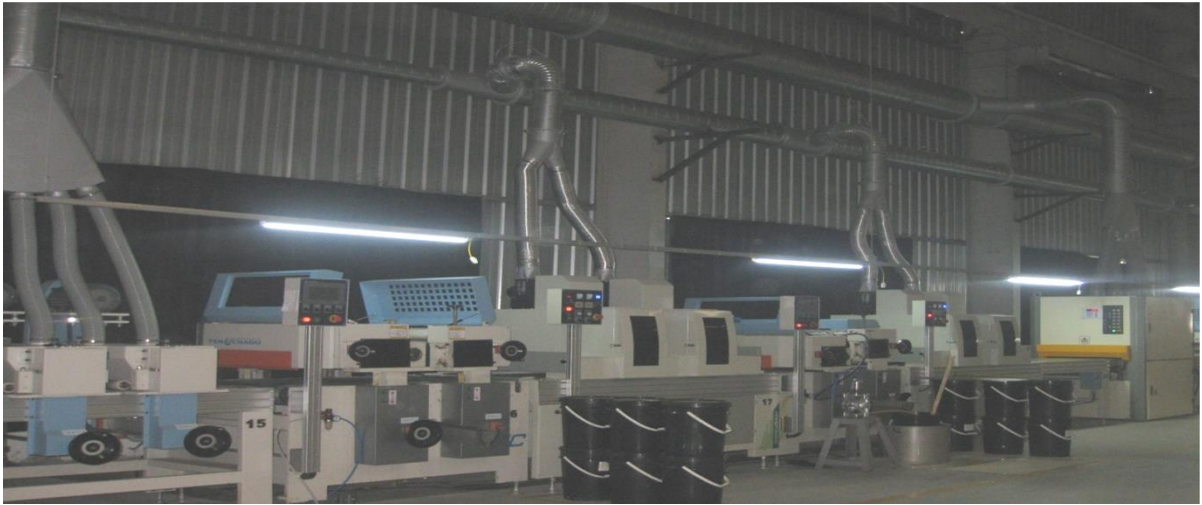
Hình 3. Hình ảnh hệ thống hút bụi và mùi trong chuyền sơn
