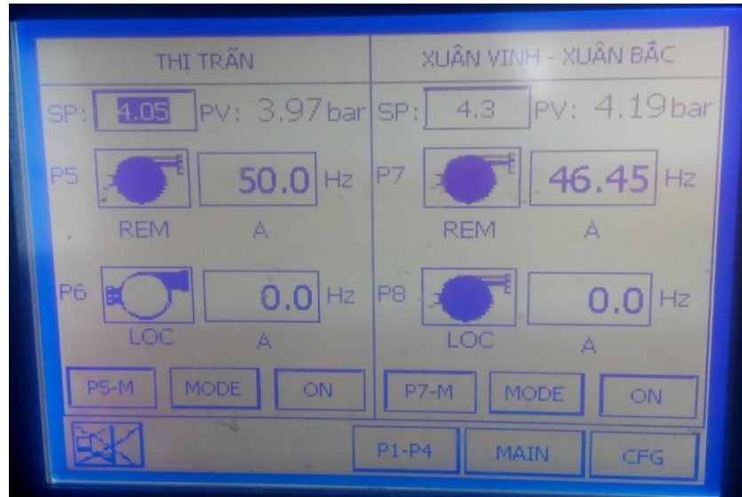
Hình 2.2.1.8: Hình ảnh màn hình HMI điều khiển cho trạm bơm
