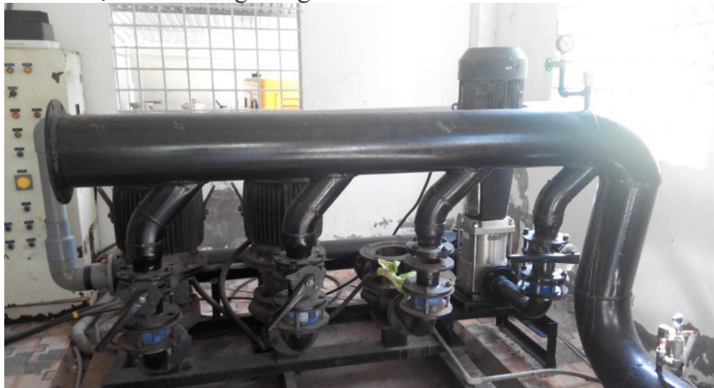
Hình 2.2.1.2: Trạm bơm cấp nước sạch 100 m 3 /h thị trấn Càng Long - Trà Vinh
