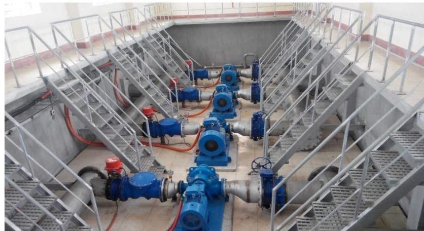
Hình 2.2.1.7: Hình ảnh trạm bơm Giao Thủy – Nam Định
