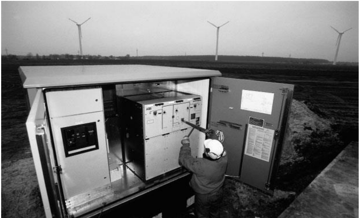
Hình 1.18: Tủ điều khiển lưới điện.
