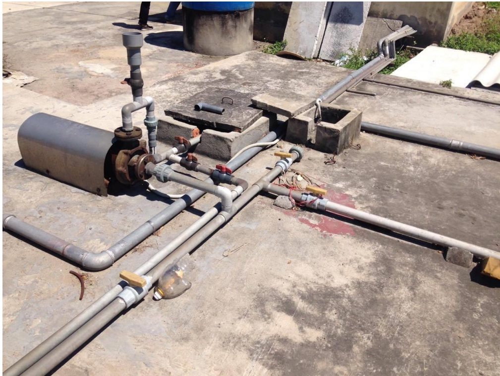
Hình 1. 3. Hệ thống xử lý nước thải của Công ty Cổ phần chế biến dịch vụ và thủy sản Cát Hải
