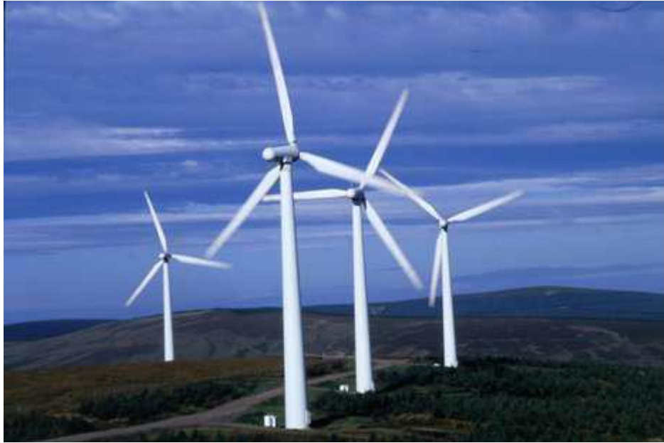
Hình 1.1. Trạm năng lượng gió
