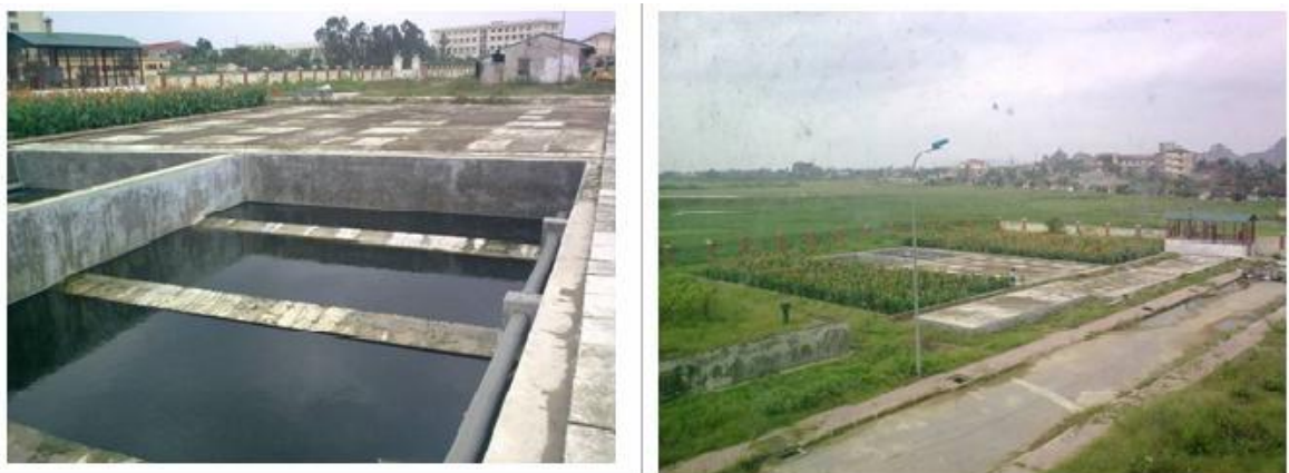
Hình 1.3. Hệ thống DEWATS tại Bệnh viện Nhi tỉnh Thanh Hóa (Công suất: 300m 3 /ngày đêm)
