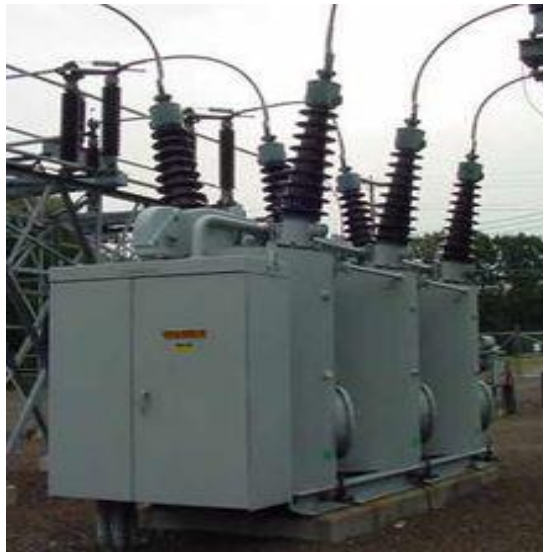
Hình 3-2. Máy cắt khí SF6-110 kV ELF- SL3-1
