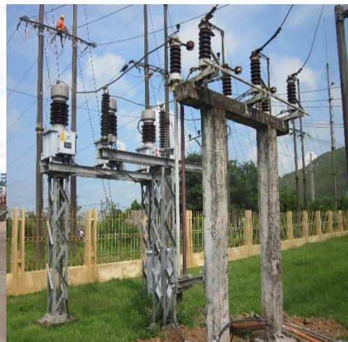
Hình 3-5. Máy biến điện áp TU- C31,35 kV
