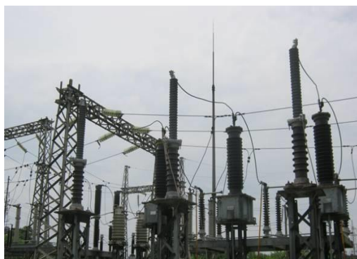
Hình 3-8. Chống sét van phân 110 kV
