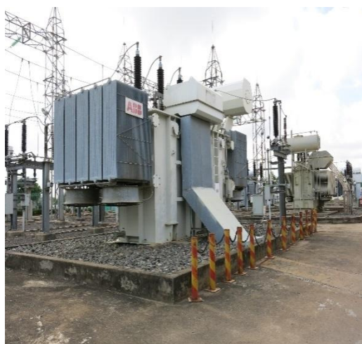
Hình 3-4. Máy biến điện áp 110kV CV 115
