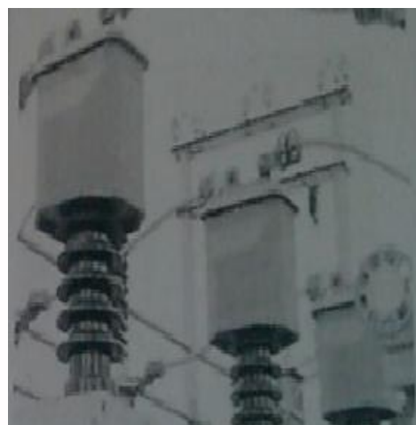
Hình 3-7. Máy biến dòng điện kiểu PNB 355
