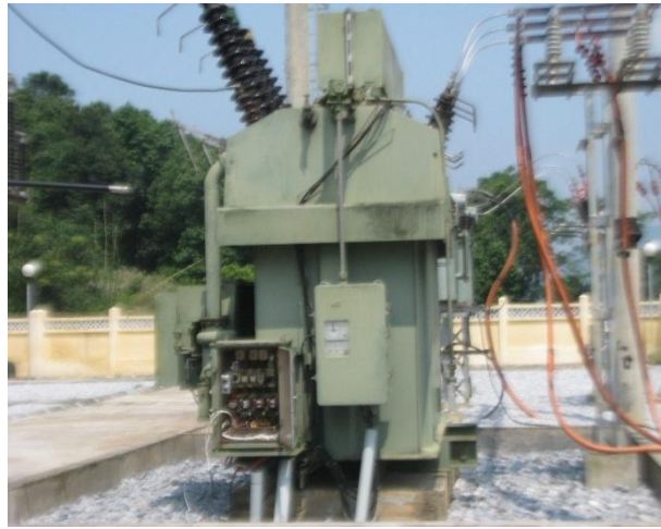
Hình 2-4. Máy biến áp 110 kV
