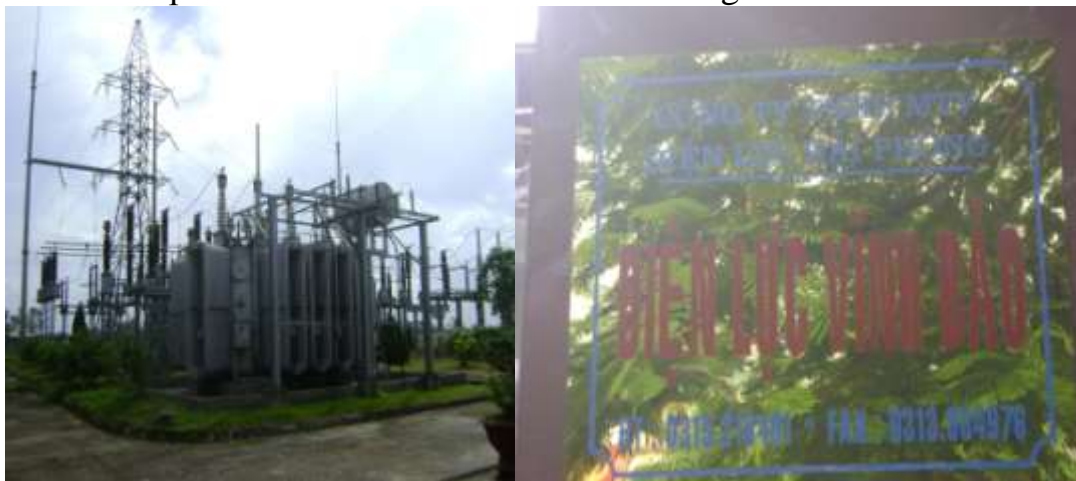
Trạm biến áp 110/35/22/10KV Vĩnh Bảo
