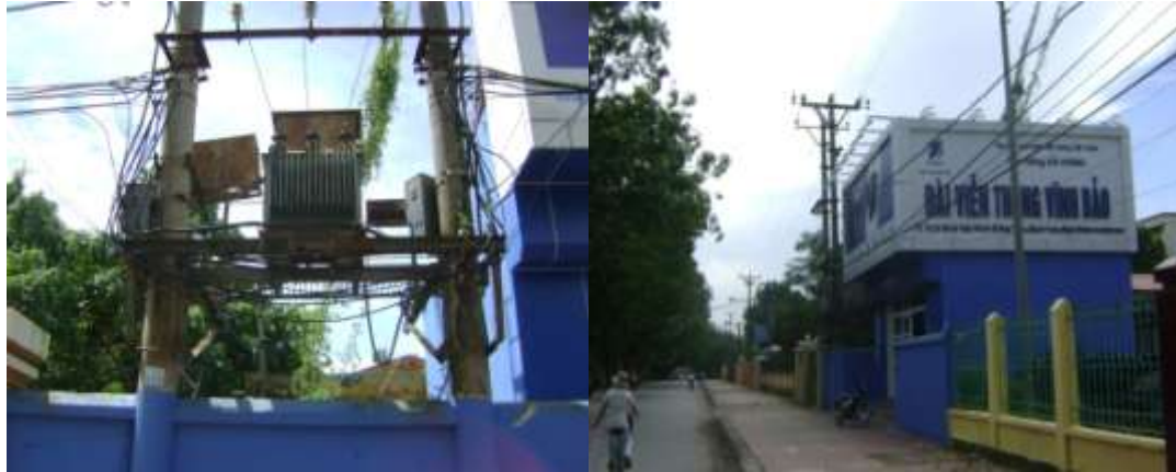
Trạm biến thế 250(KVA)
