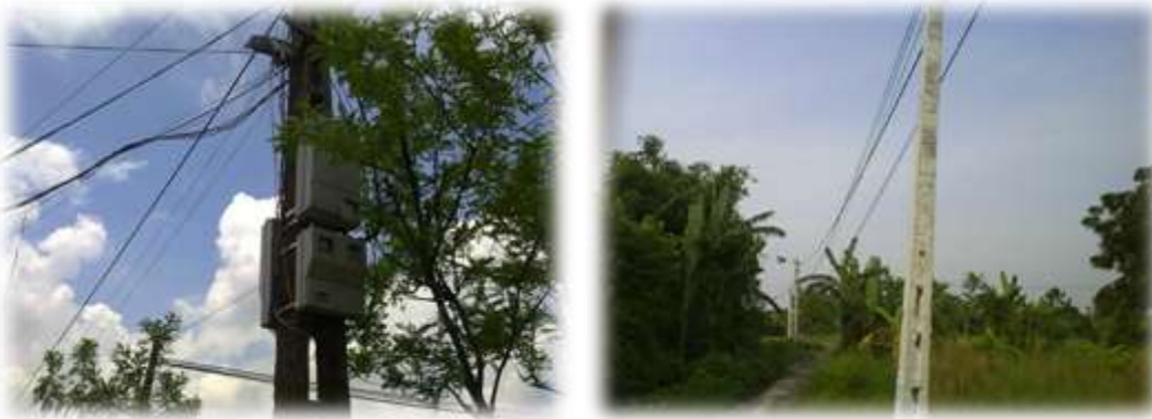
Hình 7: Đường dây điện.
