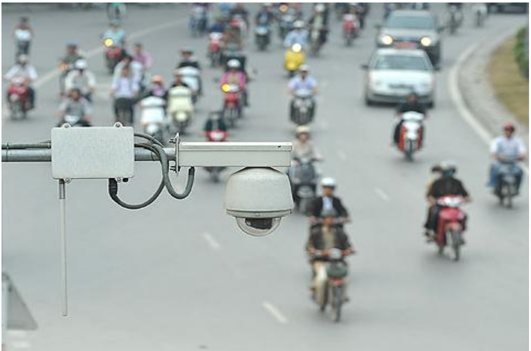
Hình 1.4: Lắp đặt các Camera giám sát tại các nút giao thông
