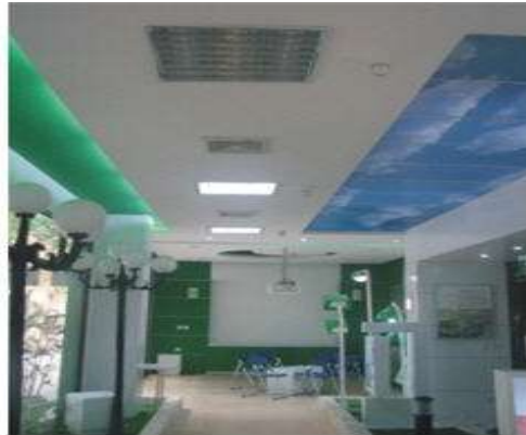
Hình 1.9. Tắt bật điện tự động ở hành lang
