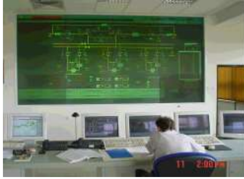
Hình 1.2: Phòng điều khiển hệ thống SCADA
