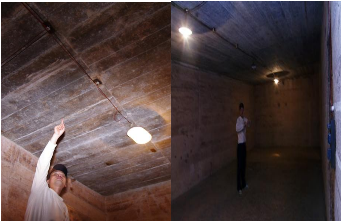
Hình 7: Hệ thống đường điện chiếu sáng tại các phòng chức năng trong bệnh viện Quân Y
