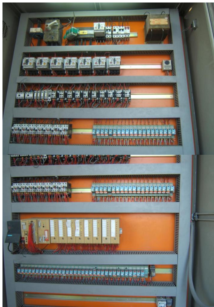
Hình 2.1: Ảnh chụp tủ điều khiển
