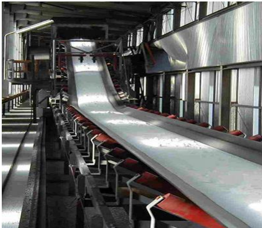
Hình 1.8: Băng tải trong nhà máy xi măng
