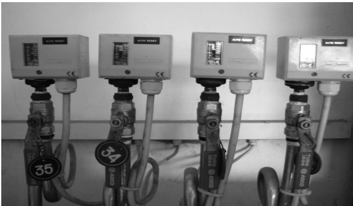
Hình 1.6. Role áp suất dùng trong hệ thống cứu hỏa của siêu thị Metro
