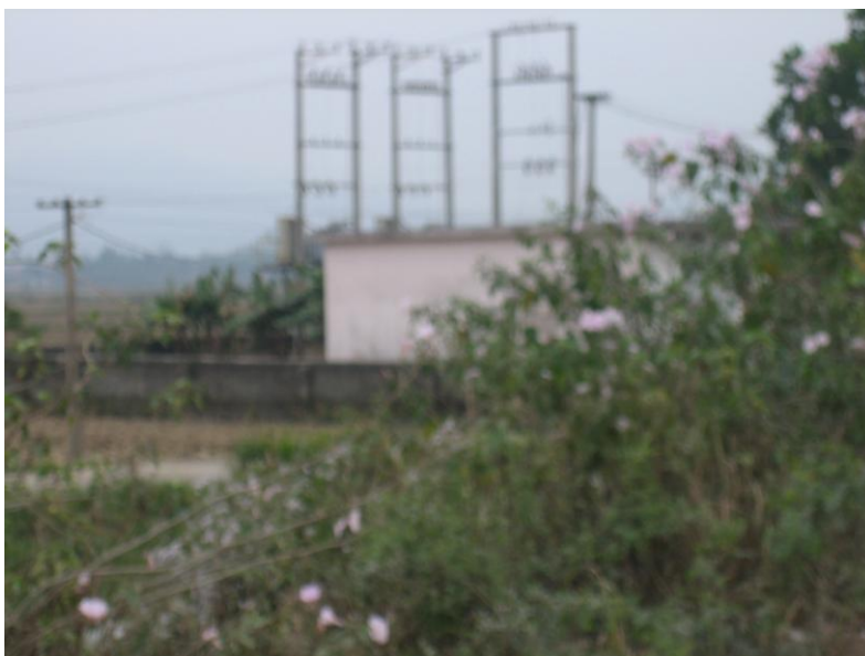
Trạm điện toàn xã
