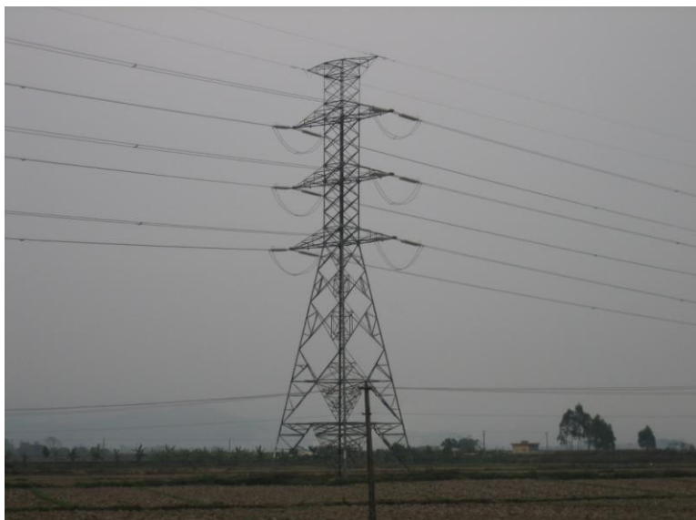
Đ-ờng dây 220 kv
