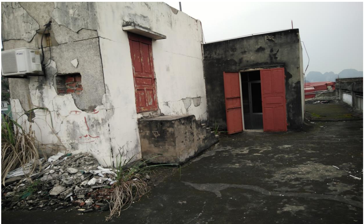
Hình 20. Chất thải đổ bừa bãi, rong, rêu, cây cỏ mọc không được dọn dẹp làm bề mặt bê tông thường xuyên bị rêu mốc, gây hư hỏng mủn, mục bề mặt bê tông
