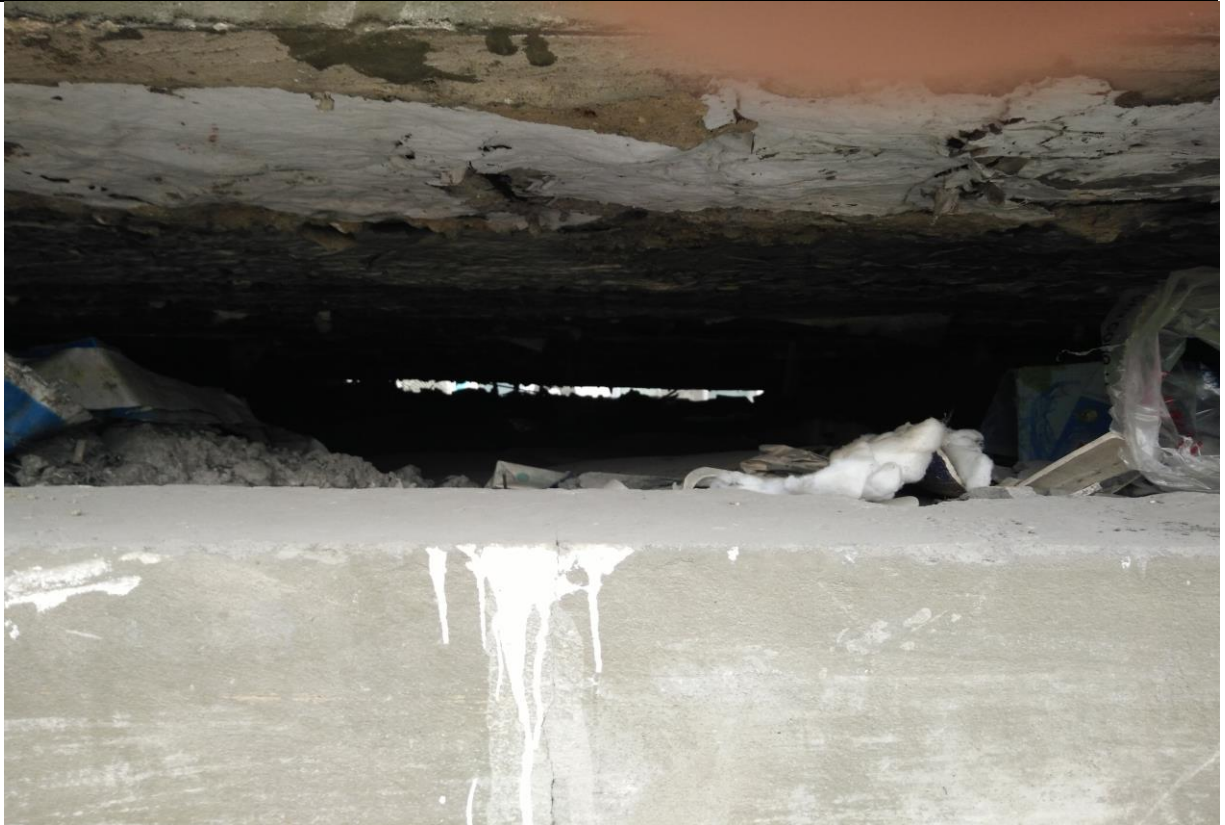
Hình 19. Chất thải đổ bừa bãi, sàn bê tông bị ẩm mốc, vỡ lớp bê tông bảo vệ
