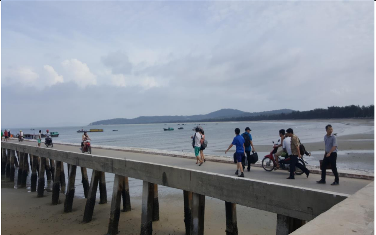
Hình 36. Các sinh vật biển (hàu, hà, sò, quéo, vẹm bám kín phần kết cấu bê tông ở vùng nước lên xuống
