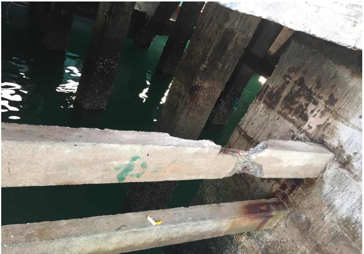
Hình 41. Bê tông dầm ngang bị ăn mòn lộ cốt thép chịu lực đang hạn chế
