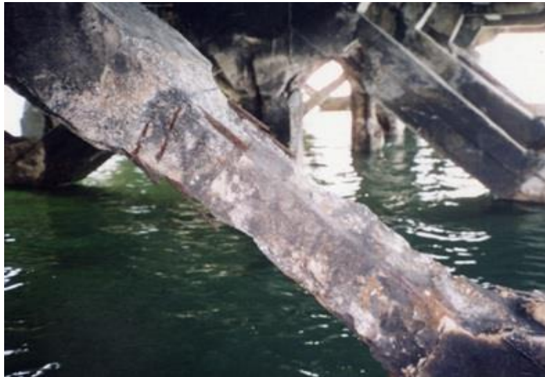
Hình 6. Xâm thực BTCT do tác động tổng hợp của mực nước thay đổi, ăn mòn cốt thép, ăn mòn bê tông trong môi trường nước biển
