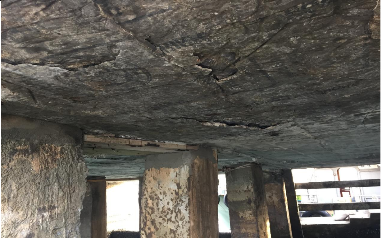
Hình 40. Bản sàn cầu cảng có một số vị trí bị nứt, bong, tách lớp bê tông bảo vệ
