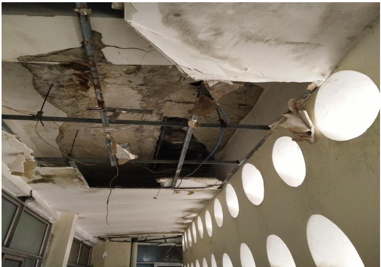
Hình 15. Mái tầng 5 bị mất găng rời lớp đáy tấm panel, cốt thép bị ăn mòn
