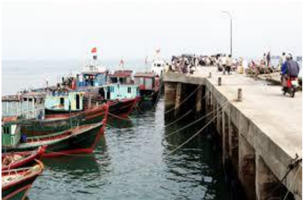
Hình 37. Ở phần nước lên xuống có hiện tượng bê tông bị bào mòn, rỗ bề mặt
