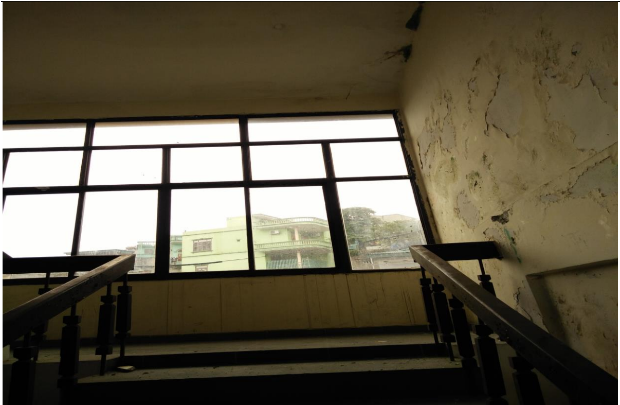
Hình 17. Tường gian cầu thang bị ẩm mốc bong rộp lớp sơn bả, vữa trát
