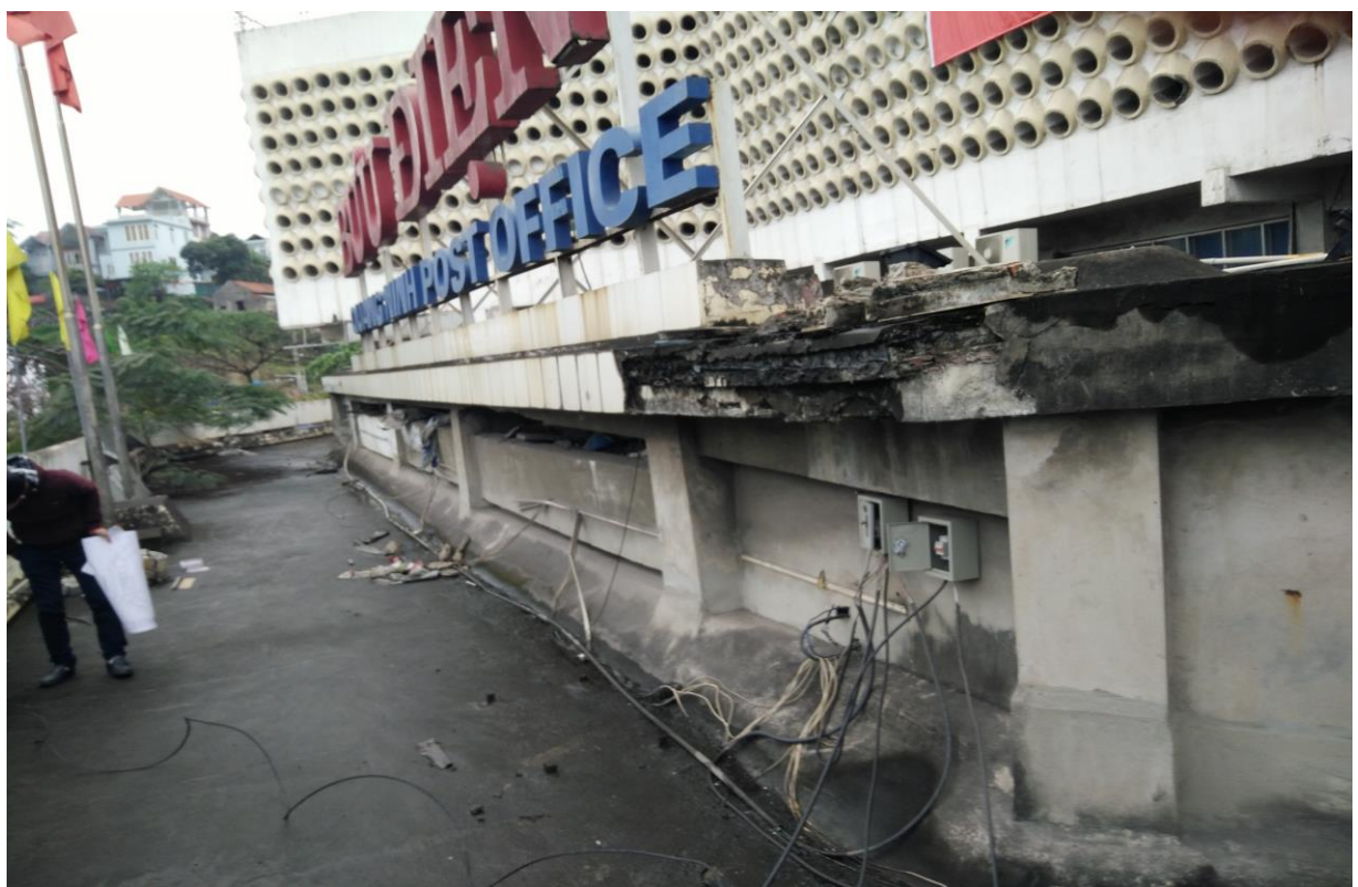
Hình 18. Mái sảnh tầng 2 bê tông bị mủn mục, gãy vỡ
