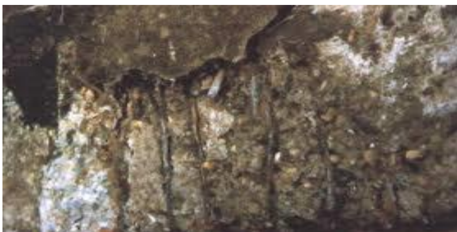
Hình 9. Ăn mòn cốt thép, bê tông do vi sinh biển (các loại hà, sò...) gây ra
