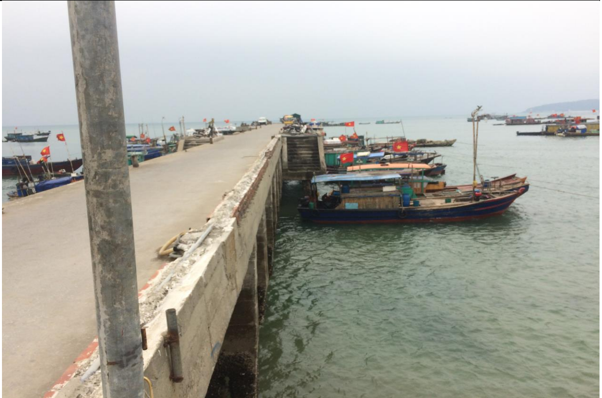
Hình 38. Bê tông lớp bảo vệ dầm bị vỡ lộ cốt thép chịu lực dài hàng mét
