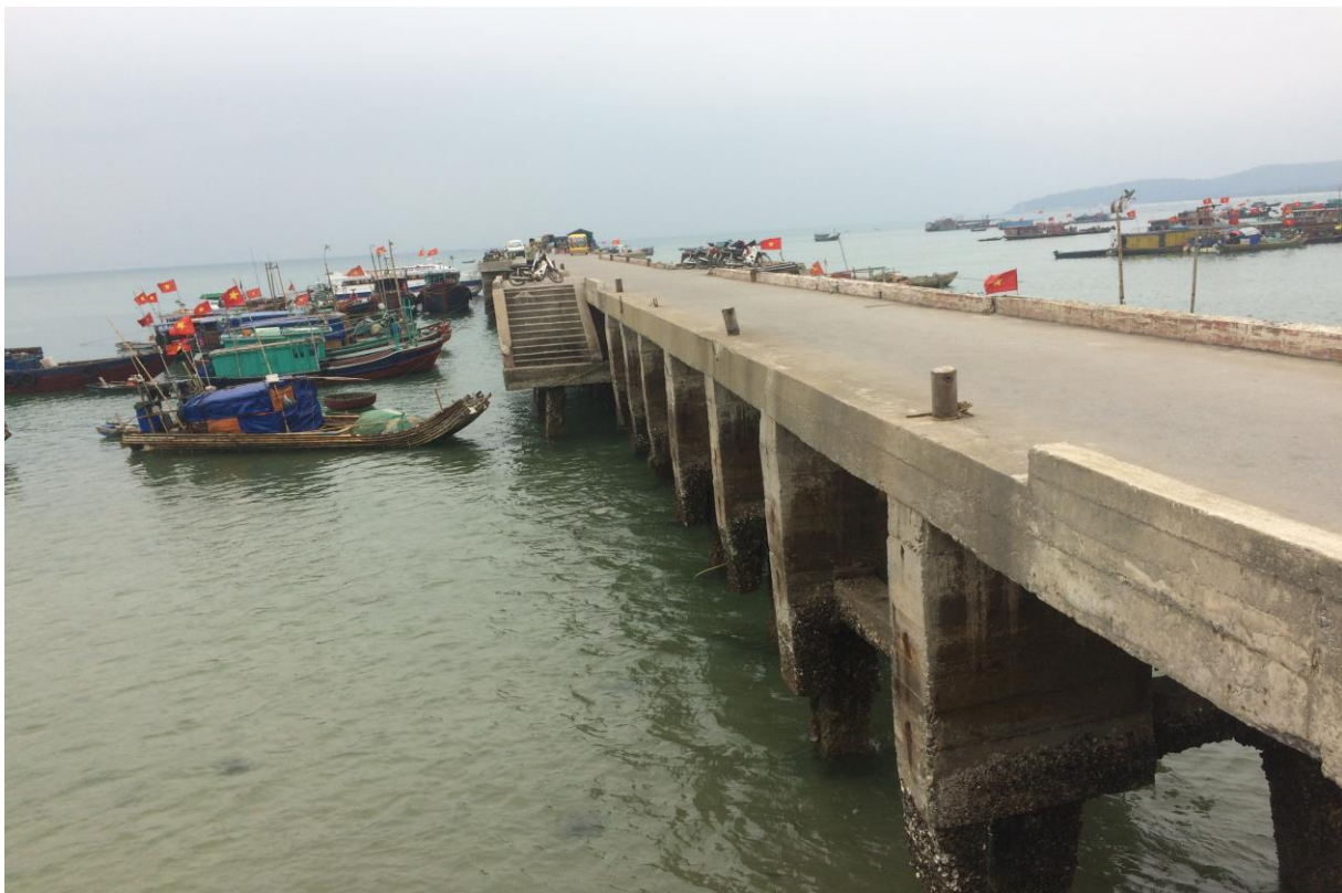
Hình 43. Một số cọc BTCT xâm thực, ăn mòn làm thu nhỏ tiết diện hoặc bị gãy
