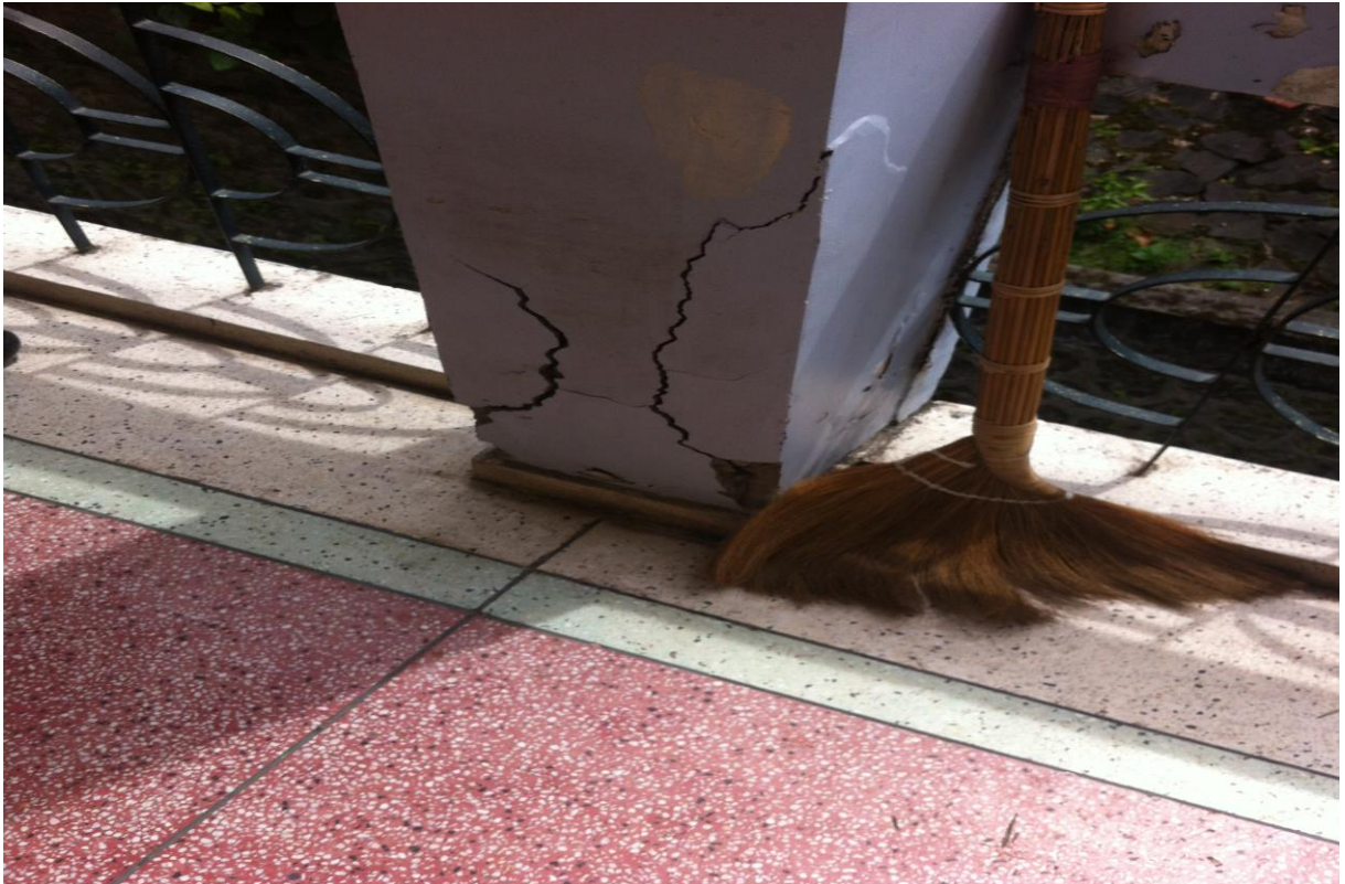
Hình 21. Cột thép bị gỉ sét nặng gây trương nở, nứt vỡ bê tông bảo vệ
