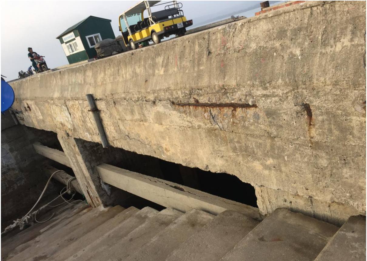
Hình 42. Cốt thép chịu lực han gỉ làm nứt vỡ bê tông dọc theo cốt thép
