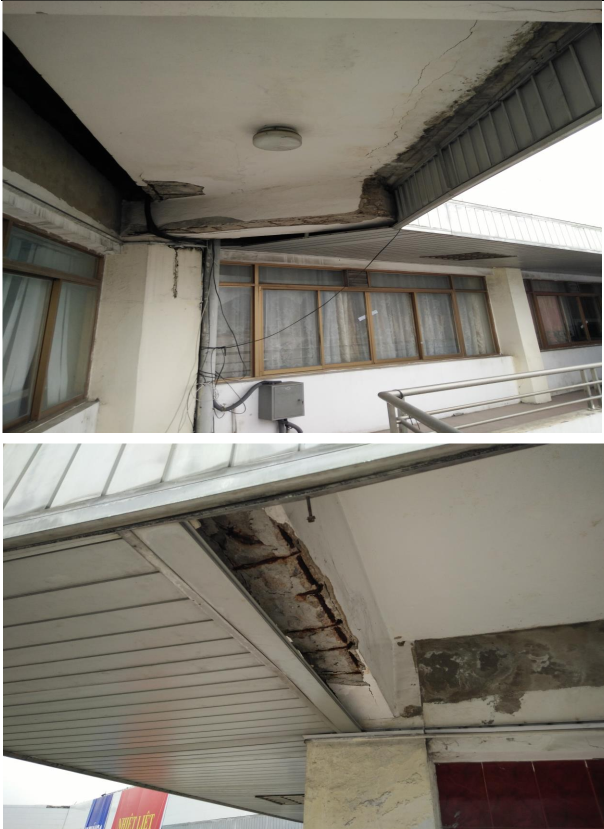
Hình 16. Mái, dầm con son tầng 5 bị vỡ lớp bê tông bảo vệ, cốt thép bị ăn mòn
