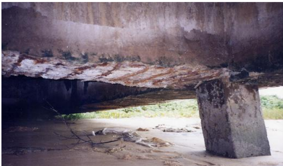
Hình 7. Ăn mòn cốt thép, ăn mòn bê tông trong môi trường nước biển do tính chất hóa học của bê tông
