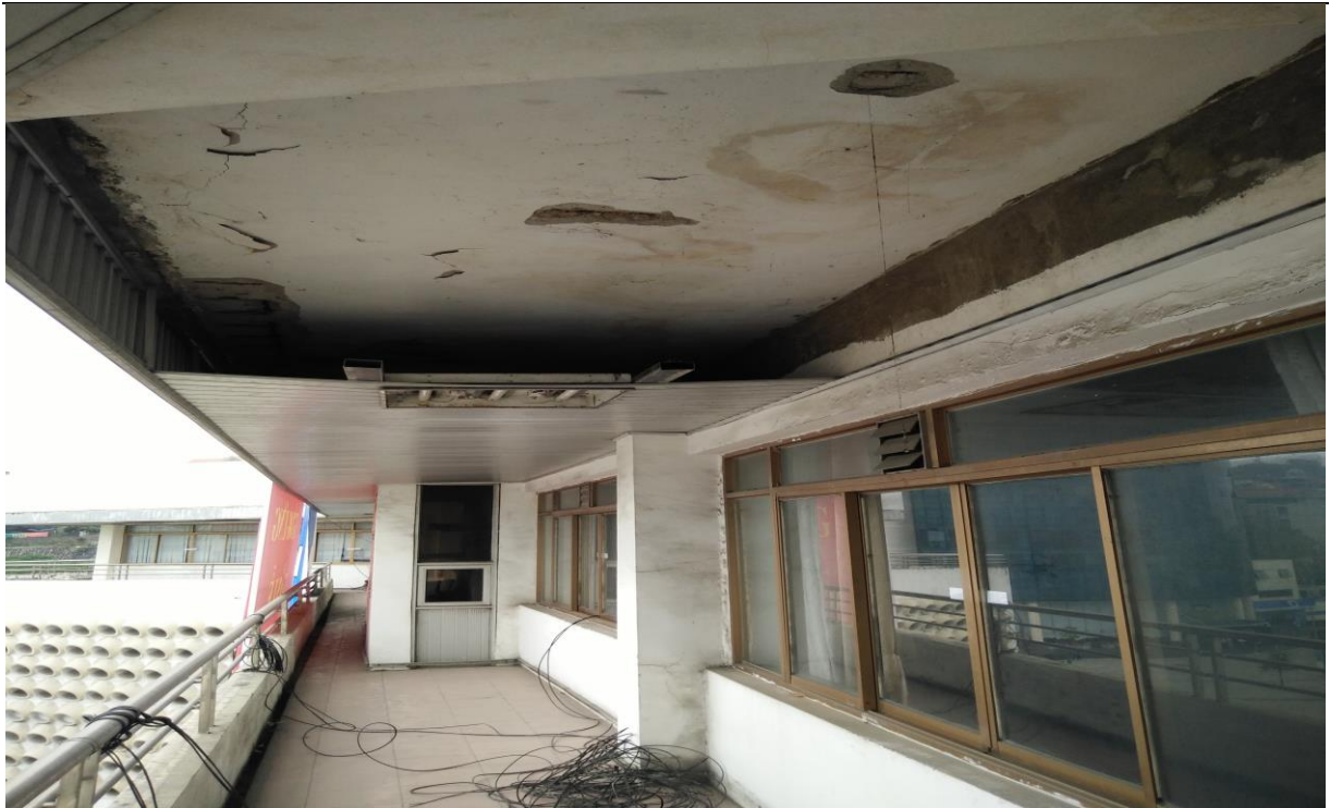
Hình 14. Trần tầng 4 bị vỡ lớp bê tông bảo vệ, cốt thép bị gỉ sét
