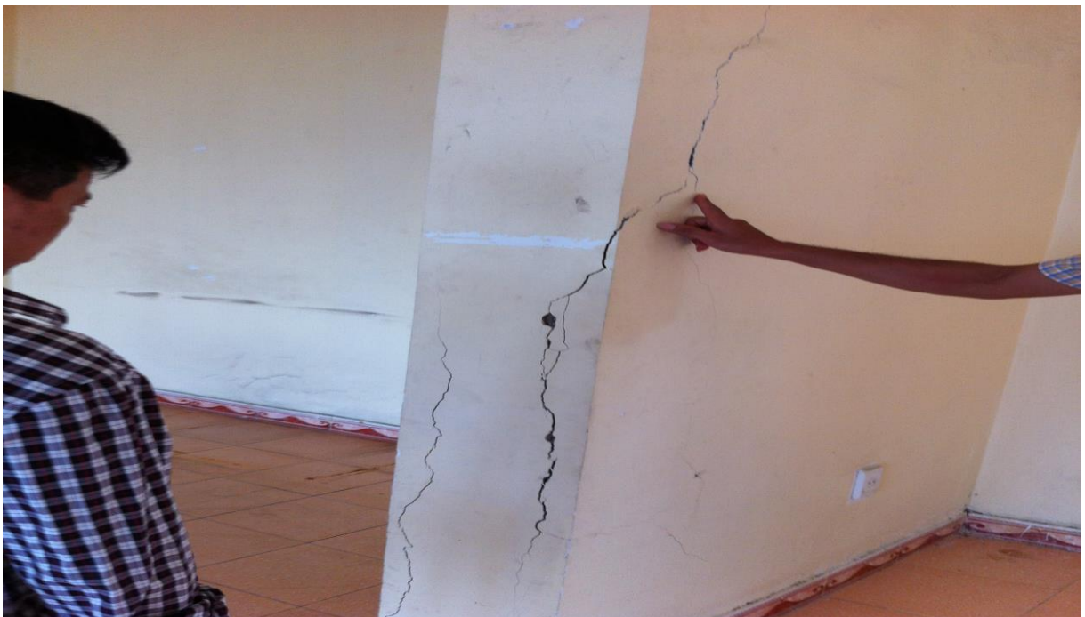
Hình 22. Cột thép dọc trong bê tông bị han gỉ, gây nứt vỡ bê tông bảo vệ và hình thành vết nứt dọc theo cốt thép dọc cột tầng 5
