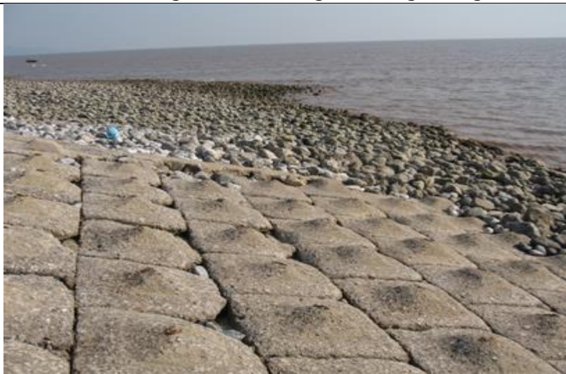
Hình 8. Bê tông bị ăn mòn cơ học do sóng biển
